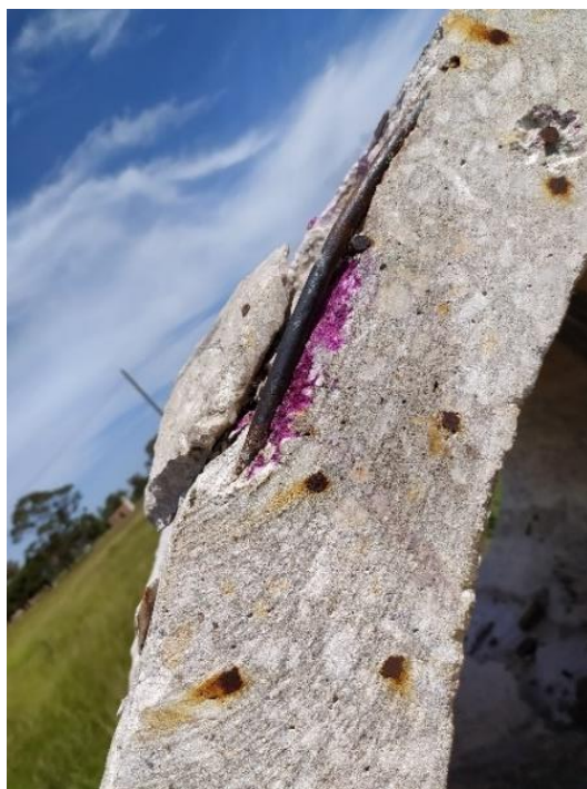
Figura 13. Estado visual de las armaduras
