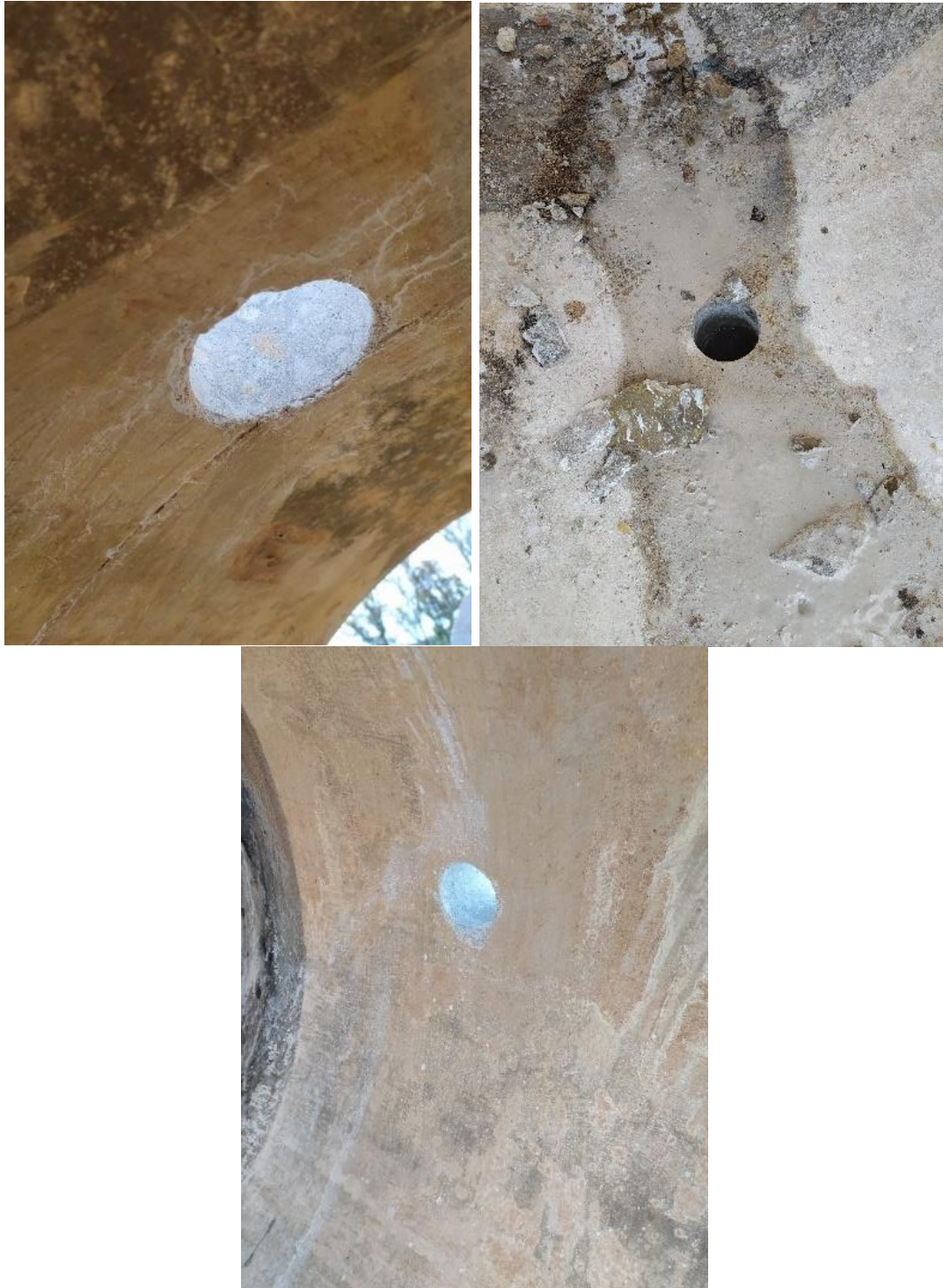
Figura 12. Superficie interna de la cañería analizada.
