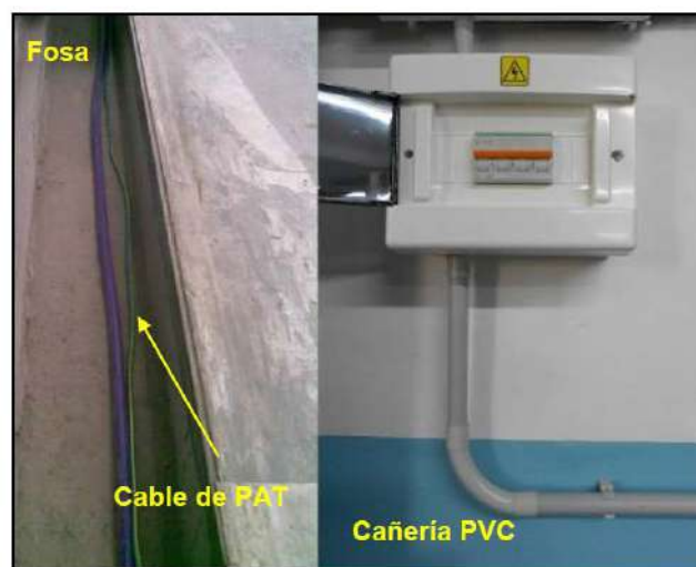
Figura 4.4: Canalización interna-Fosa (izquierda) y externa-Caño PVC (derecha).
