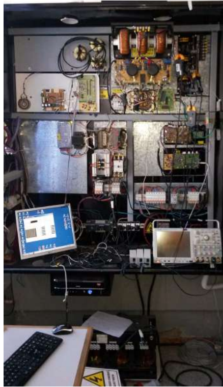
Figura 6.3: Foto del inversor desarrollado en el LIC para inyectar corrientes a la red.
