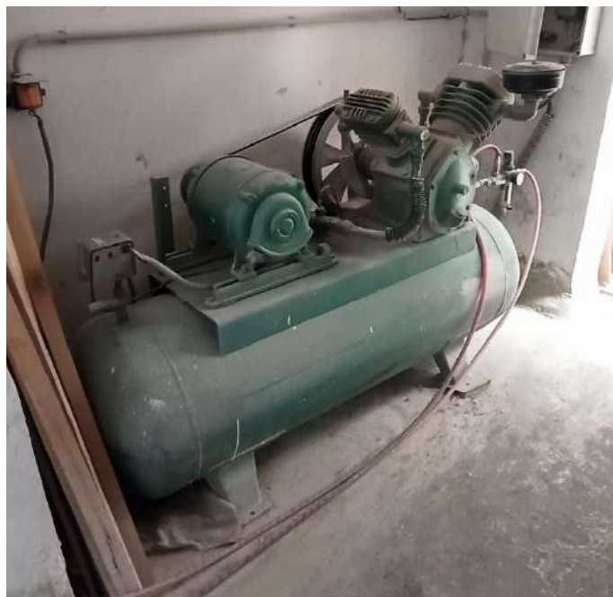
Figura 3.2.3.26 C3C: Compresor de cabina de pintura de 1,1kW de potencia.
