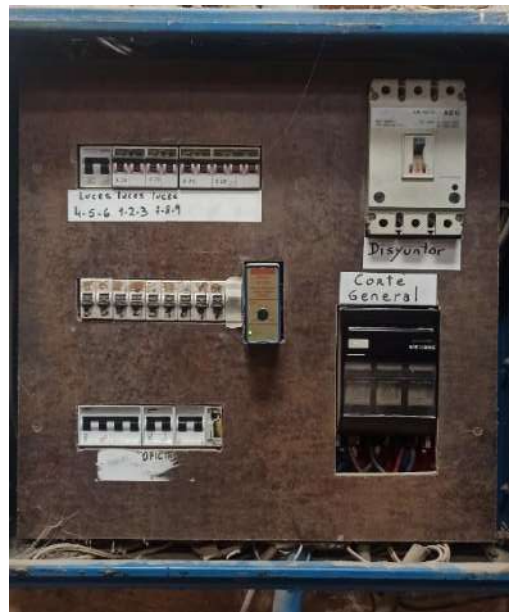
Figura 3.2.3.21 B2TP: Tablero principal. Controla la iluminación del galpón y la distribución.
