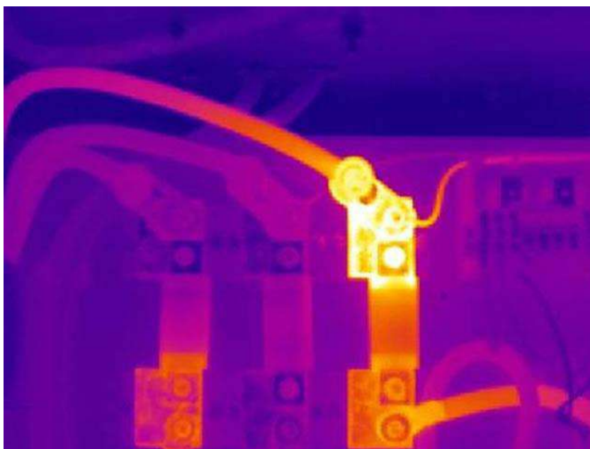
Figura 3.3.1.2 Ejemplo de punto caliente en borne sin correcto ajuste. Se observa como la temperatura decrece a medida que se aleja del punto caliente. [31]
