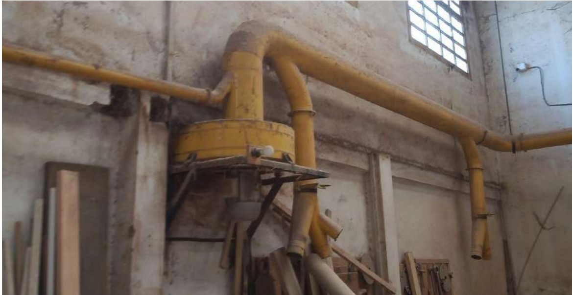
Figura 3.2.3.9 AE/1: Motor 1 del sistema de extracción general de 4kW de potencia.
