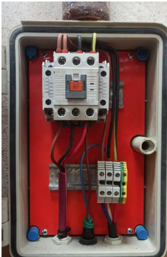
Figura 3.3.1.6 Tablero del compresor AC. Tablero de una sola toma.
