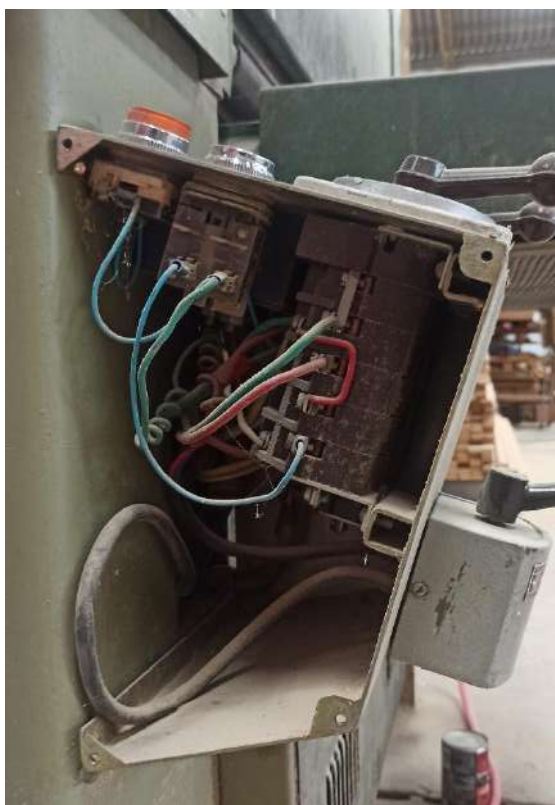
Figura 3.3.1.10 Tablero eléctrico del equipo B2C lijadora de contacto. Se observa la aglomeración de equipos que dificulta la identificación de cada elemento.
