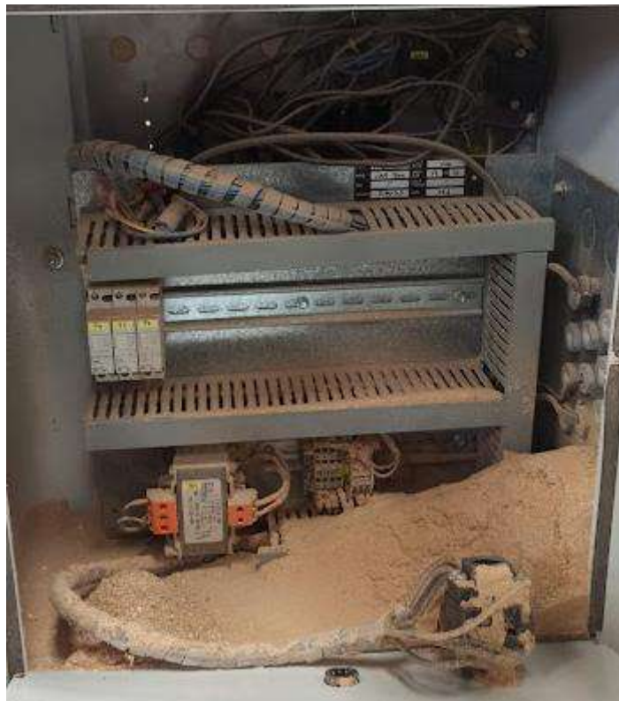
Figura 3.3.1.1 Tablero de escuadradora con el aserrín acumulado de una semana sin limpieza.
