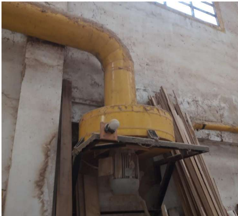
Figura 3.2.3.10 AE/2: Motor 2 del sistema de extracción general de 4kW de potencia.
