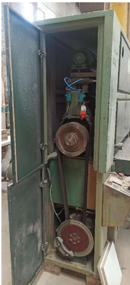
Figura 3.3.1.9 Gabinete del activo B2C lijadora de contacto. Existe riesgo de atrapamiento por las correas tan cerca de la puerta.
