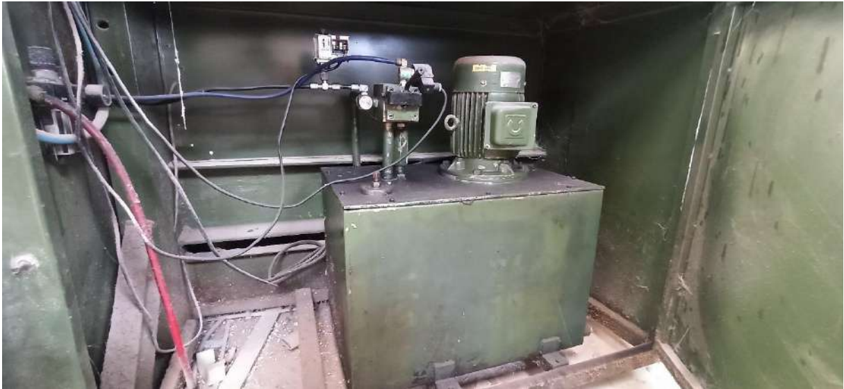
Figura 3.3.1.11 Gabinete del motor de la prensa hidráulica B2P. Se cuenta con un amplio espacio para realizar las mediciones.
