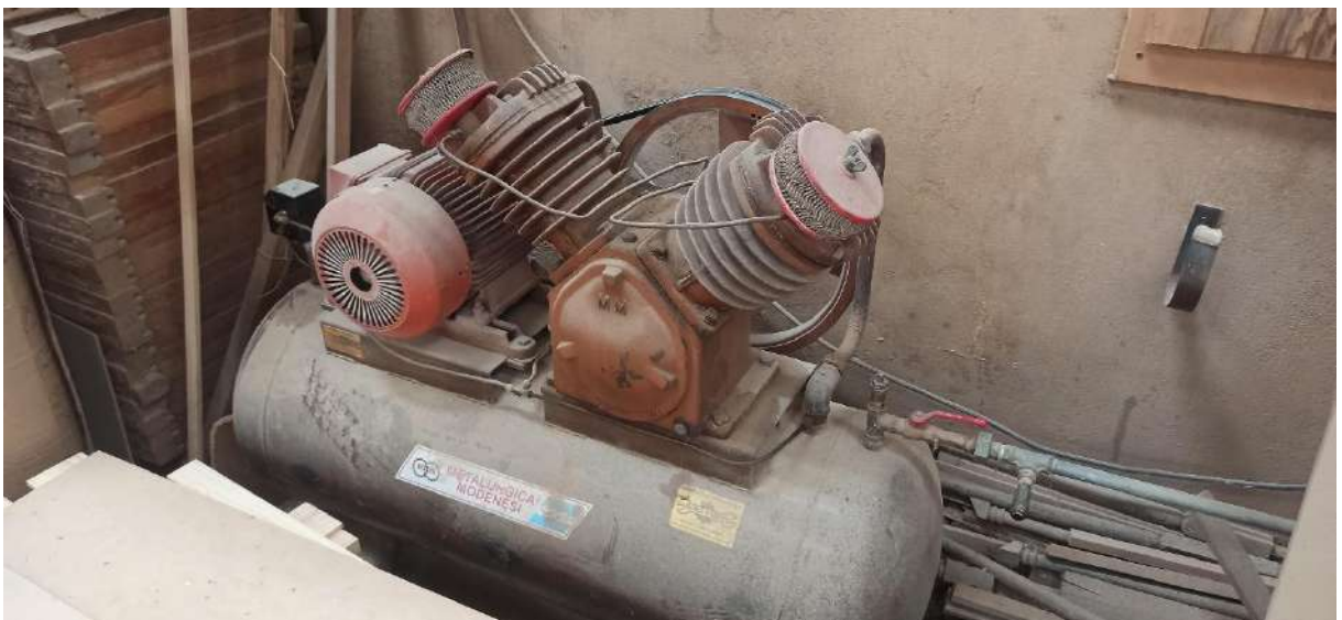
Figura 3.2.3.8 AC: Compresor de 2,2kW de potencia marca Metalúrgica Modenesi.
