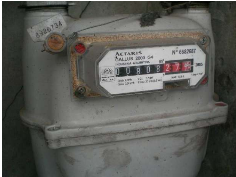
FIGURA 6-6 Medidor de gas
