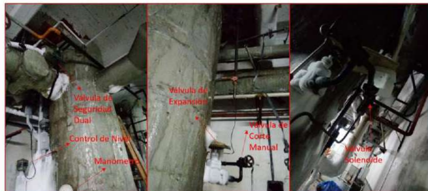
Figura 15: Separador de Baja 1 y sus características
