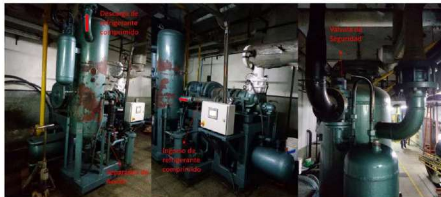
Figura 17: Separador de Aceite de Compresor Mycom N°1 y sus características
