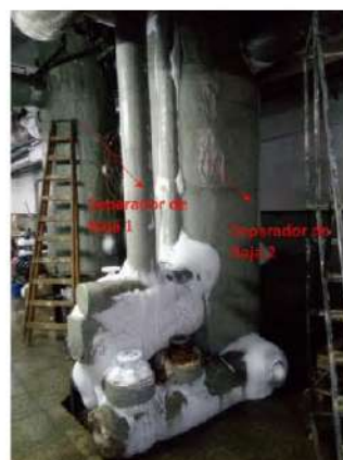
Figura 5: Separador de Baja 1 y Separador de Baja 2
