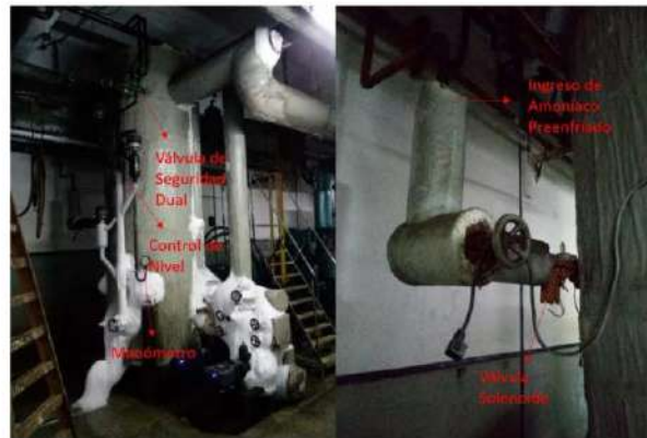
Figura 16: Separador de Baja 2 y sus características
