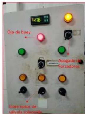
Figura 29: Tablero Eléctrico N°9
