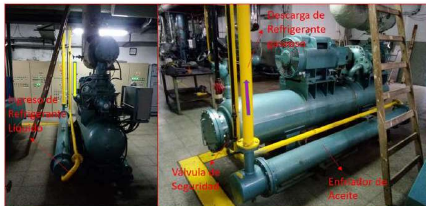
Figura 22: Enfriador de Aceite de Compresor Mycom N°3
