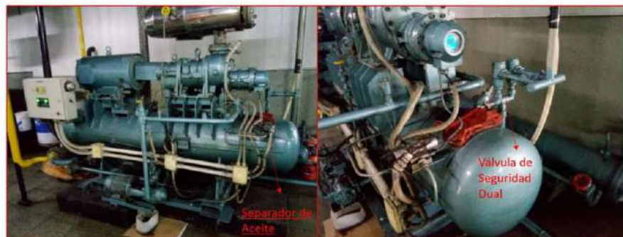
Figura 19: Separador de Aceite de Compresor Shantai N°2 y sus características
