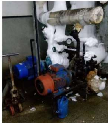
Figura 6: Bombas de circulación de Separador de Baja 1
