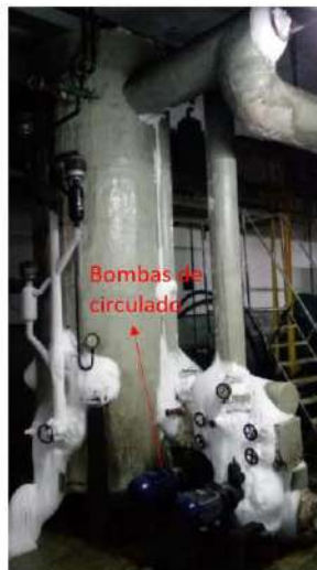
Figura 7: Bombas de circulación Separador de Baja 2
