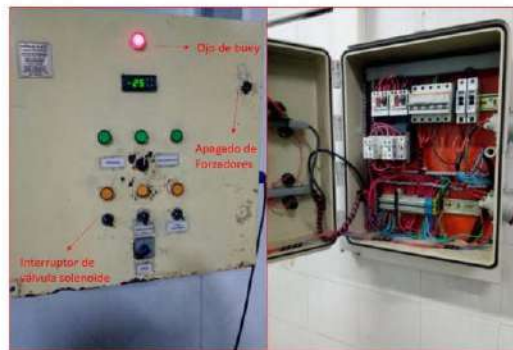
Figura 28: Tablero Eléctrico N°10
