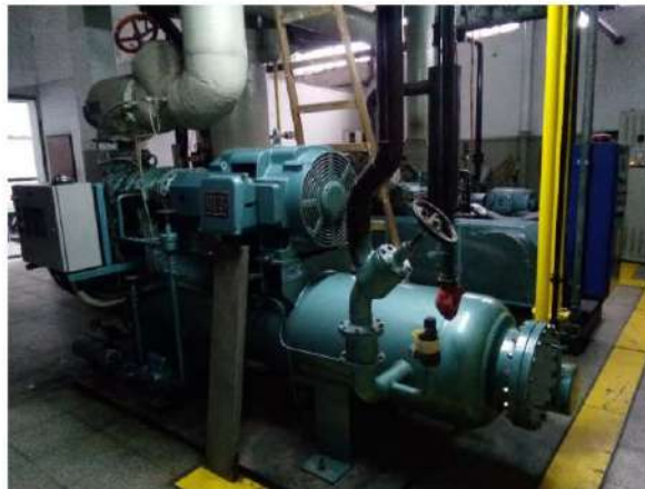
Figura 10: Compresor a tornillo Mycom N°3
