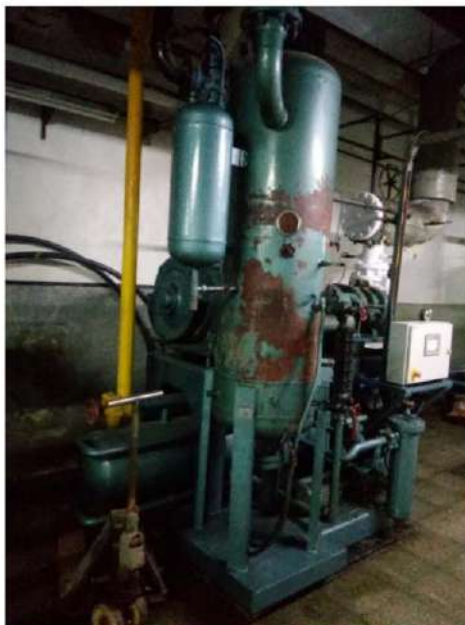
Figura 8: Compresor a tornillo N° 1 Mycom
