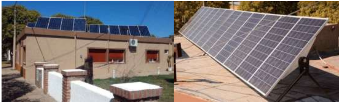
Figura 7: Instalación fotovoltaica Municipalidad de Oleata Fuente: La Ribera (2018)
