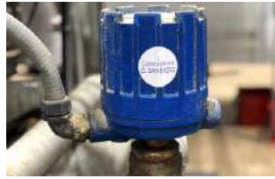
Figura 59: Etiqueta para señalar tapado de válvulas, sensores, tableros, motores etc. Fuente: Información relevada de la compañía.
