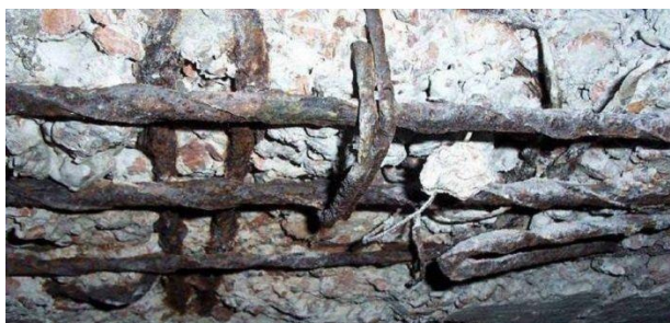
Figura 1. Estructura de hormigón armado dañada por corrosión.
