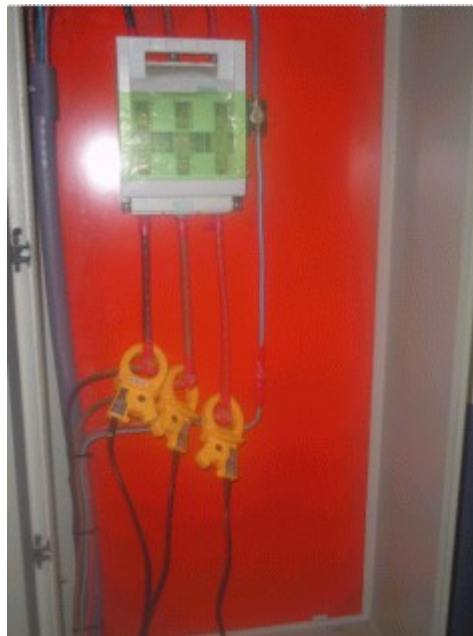
Figura 160- Tablero para compresores.
