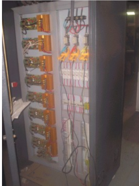
Figura 153-Tablero 1 (soplado de botellas e iluminación).
