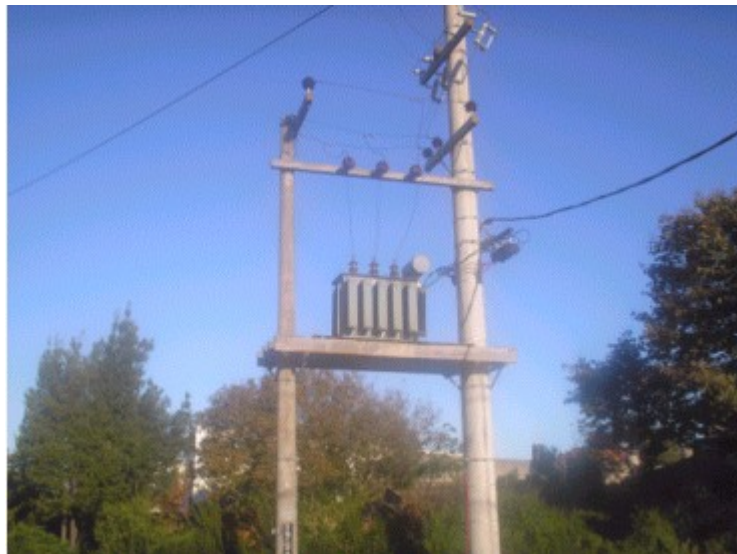
Figura 163-Transformador de potencia cercano a la instalación (20 metros).
