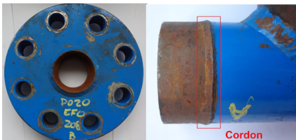
Figura 3.8: Componentes cuyas partes están físicamente separadas (pérdida completa de la unión).
