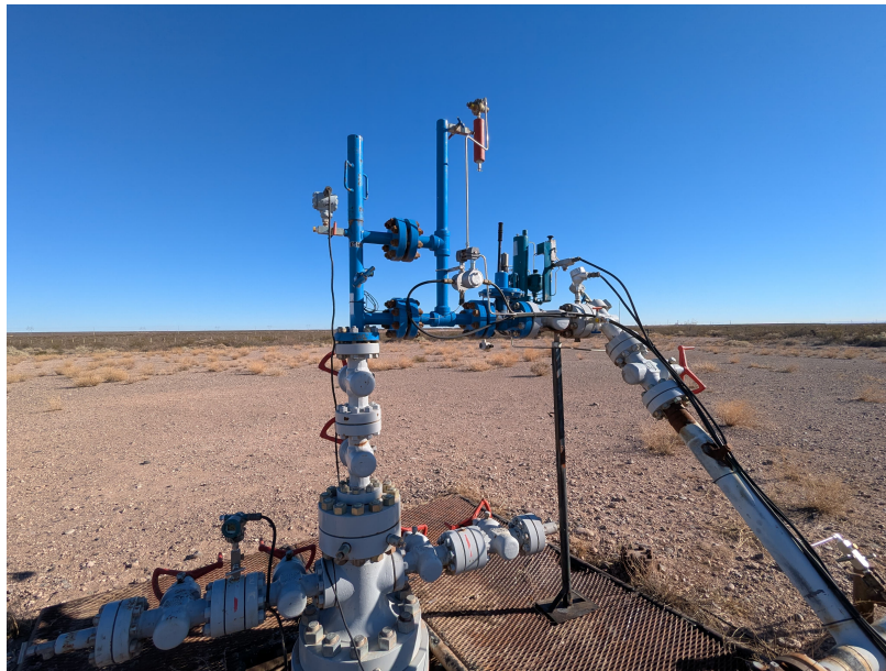
Figura 2.12: Instalación plunger lift real
