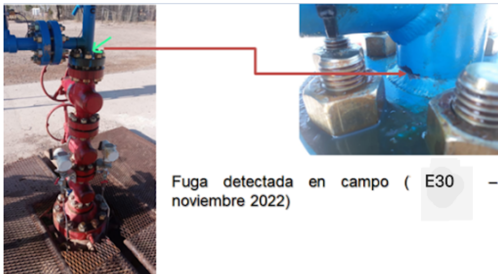
Figura 3.2: Caso tipo de falla en costura de lubricador - pozo E30.
