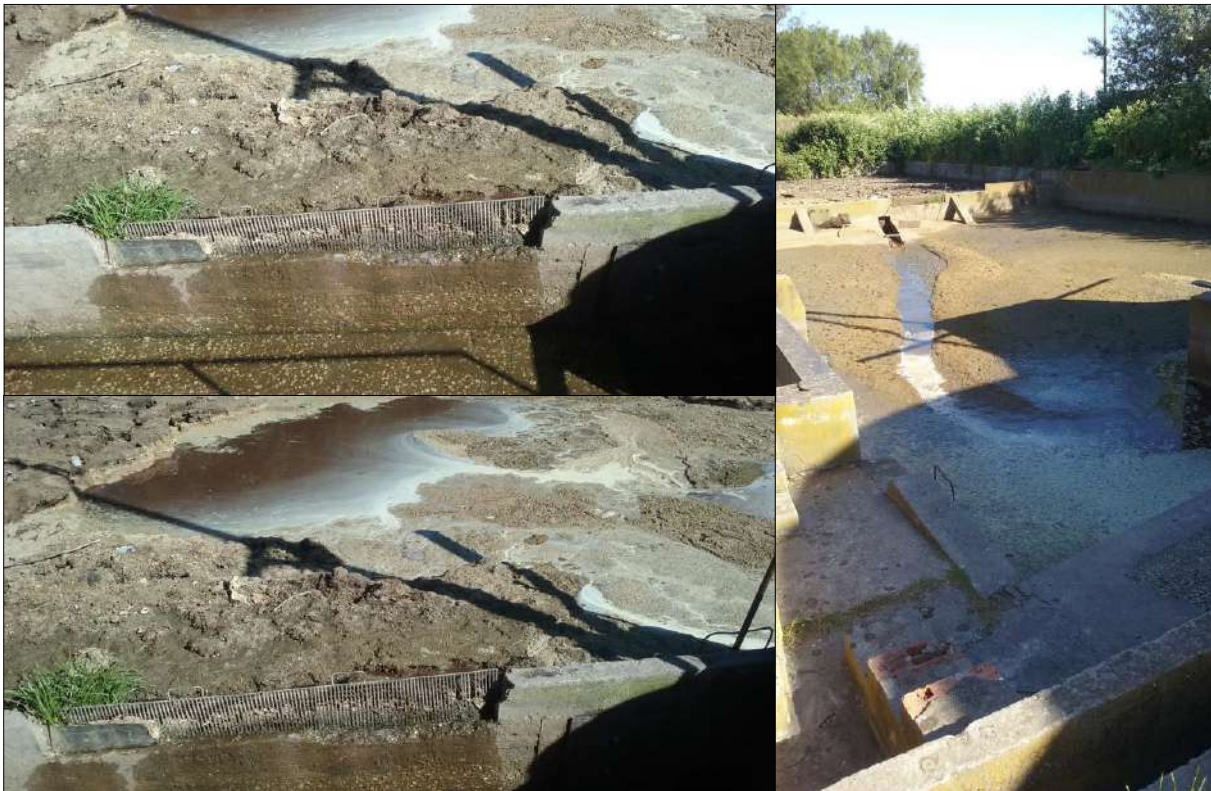
A – 6.3.5. Rejas de la zona de filtrado.
