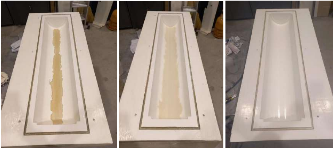
Figura 4.27. Estado del molde luego del lijado, masillado y aplicación del gel coat .
