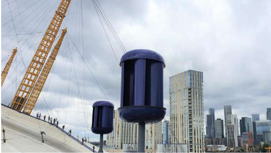
Figura 1.12. Turbinas de Alpha 311 instaladas en el O 2 Arena.
