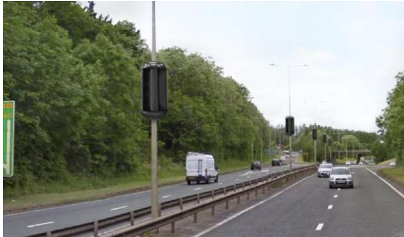
Figura 1.11. Turbinas de Alpha 311 instaladas en una autopista.
