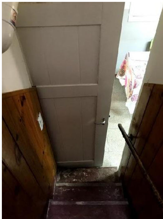
Figura 10: Ingreso a la escalera obstruido por la puerta del “sanitario 3”. Fuente: Elaboración propia
