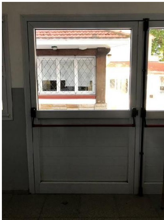
Figura 8: Puerta perteneciente al SUM de aluminio con partición de vidrio y barral antipánico. Fuente: Elaboración propia
