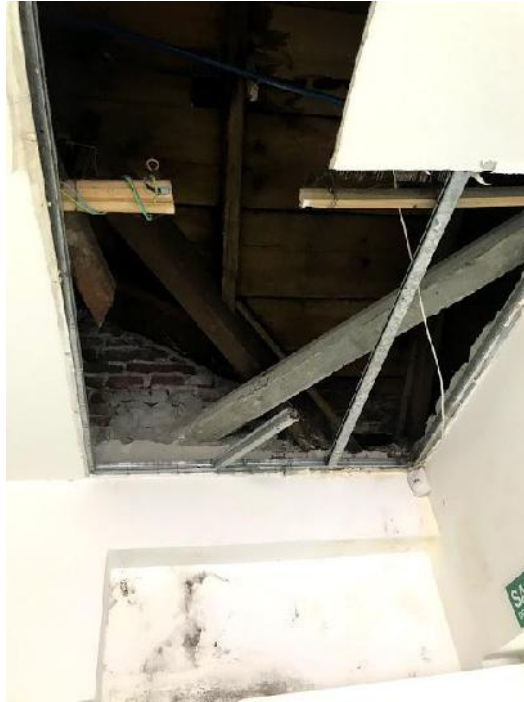
Figura 18: Placas de yeso rotas. Fuente: Elaboración propia
