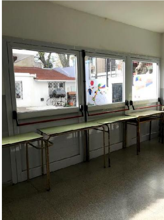
Figura 3: Salida de emergencia del SUM obstruida. Fuente: Elaboración propia
