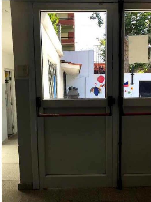
Figura 7: Puerta principal de aluminio con partición de vidrio y barral antipánico. Fuente: Elaboración propia
