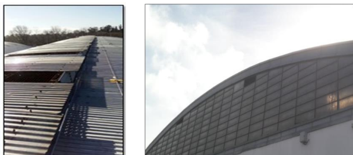
Figura 63: Roturas edilicias: ventanales y chapas traslucidas en mal estado Fuente: Elaboración propia
