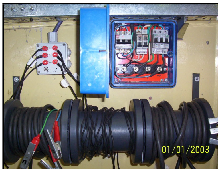
Foto 11: Bornera de Paso
