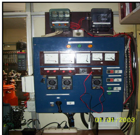
Foto 5: Tablero General de medición.
