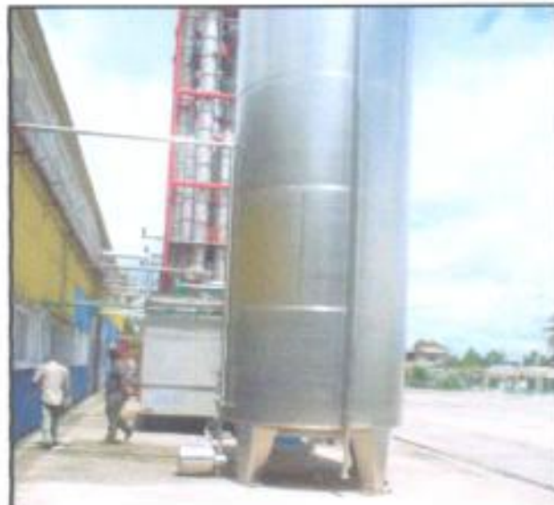
Tanque para la recuperación del concentrado
