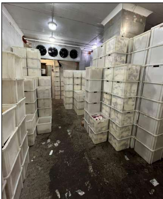
Figura 17: Cámara frigorífica de producto final 1 (CF1)
