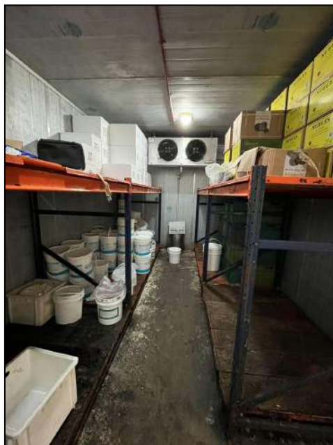
Figura 13: Cámara frigorífica para materia prima
