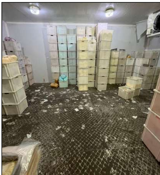
Figura 18: Cámara frigorífica de producto terminado 2 (CF2)
