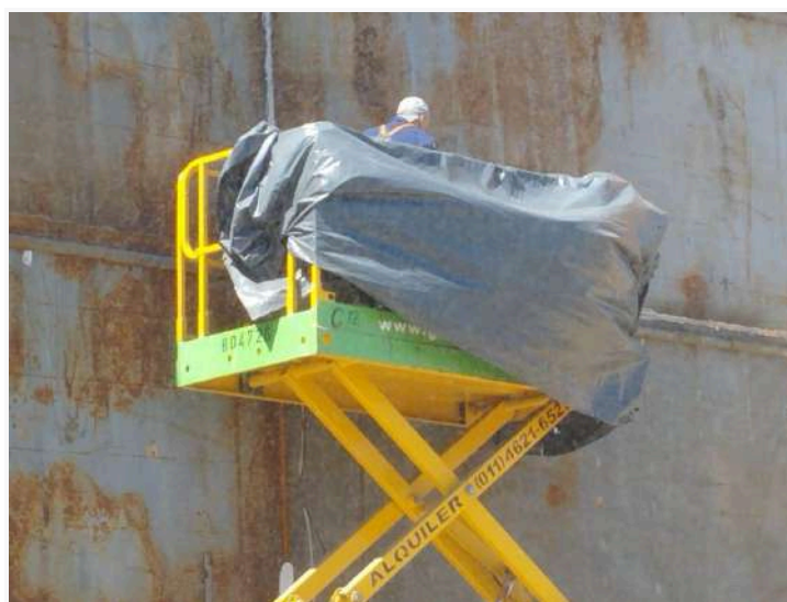
Figura 11: Operarios utilizando carpas de seguridad rudimentarias.
