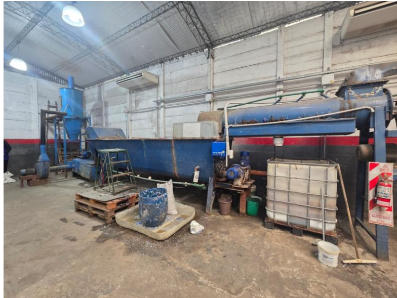
Figura 2-9: Sector de lavado de escamas
