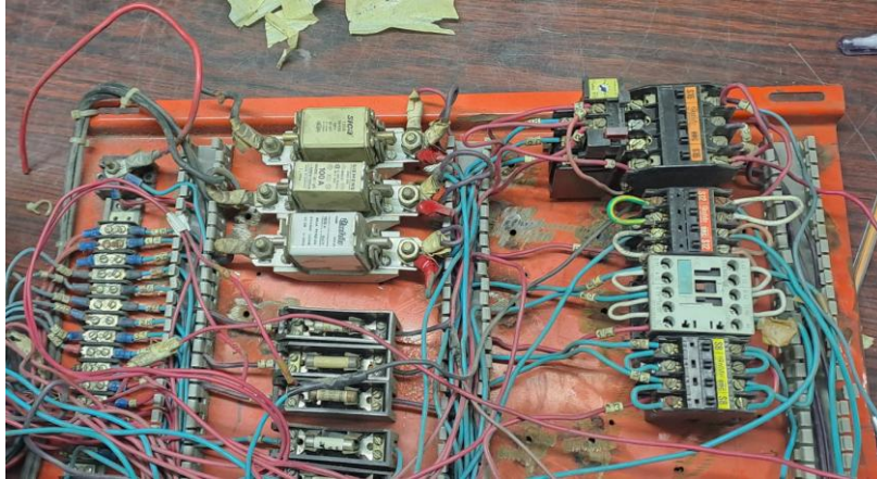
Figura 5-39: Tablero General de Control y Potencia. Imagen Propia
