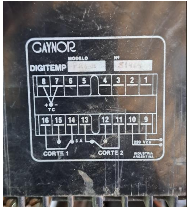
Figura 5-37: Pirómetro original. Imagen propia.
