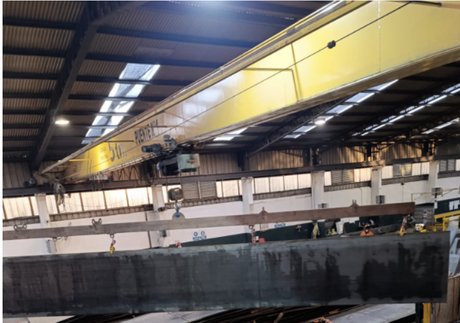
Figura N° 9: Puente grúa y chapón de 12 metros. Fuente: Imagen tomada en las visitas a la empresa.
