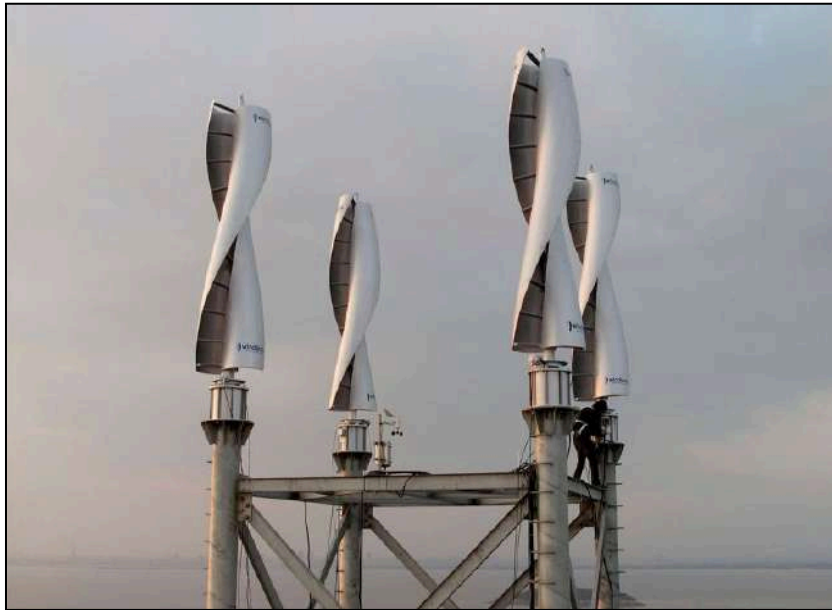
Figura 6.3 - Aerogenerador de eje vertical
