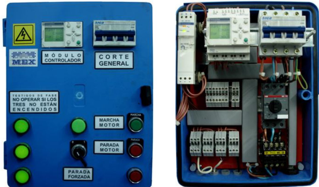
Figura D.5: Vista frontal del tablero de control, se observa la disposición de los elementos de mando y aparatos de maniobra.
