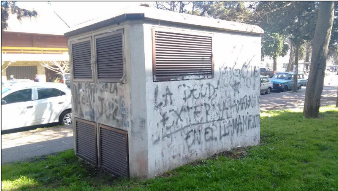
Fig. 1.4. Subestación Rodriguez Peña (S2)
