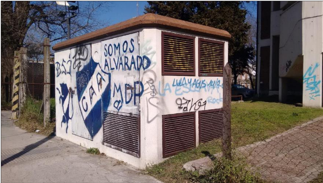
Fig. 1.2. Subestación calle Dean Funes (S1)
