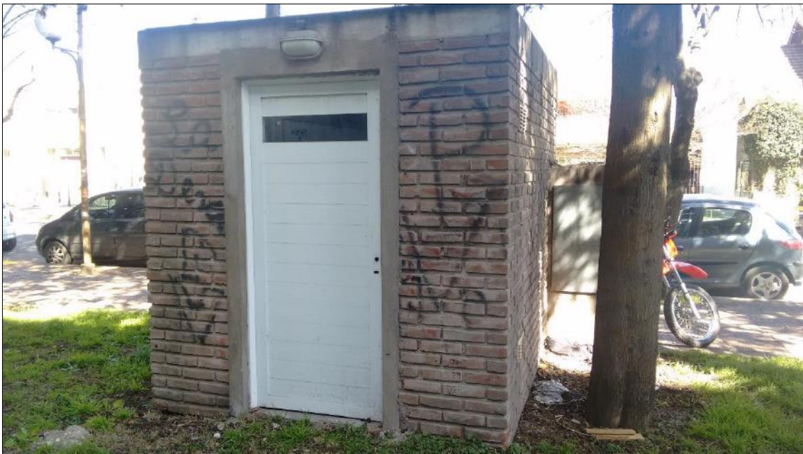
Fig. 1.5. Tablero Primario Subestación S2
