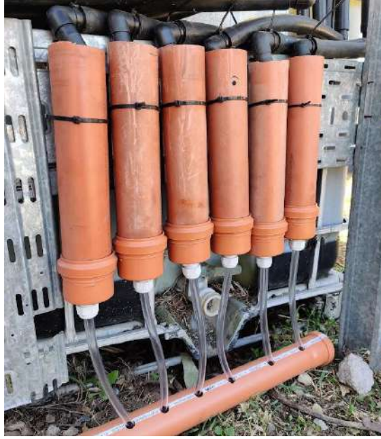
Figura 3.4. Columnas del sistema de biofiltros.
