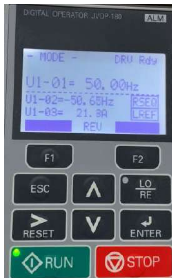
Figura 6.52 – Pantalla del variador de frecuencia durante el funcionamiento del montacargas (Fuente: Elaboración propia)
