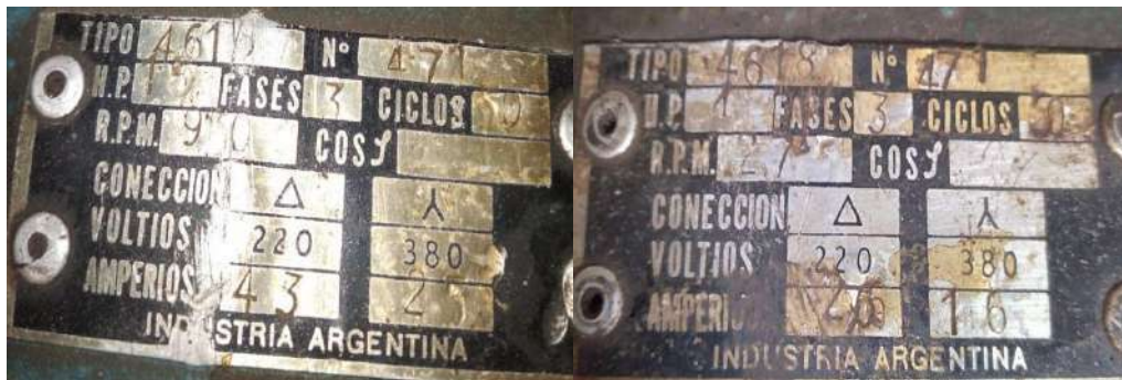
Figura 6.2 - Chapa característica montacargas 2 (Fuente: Elaboración propia)
