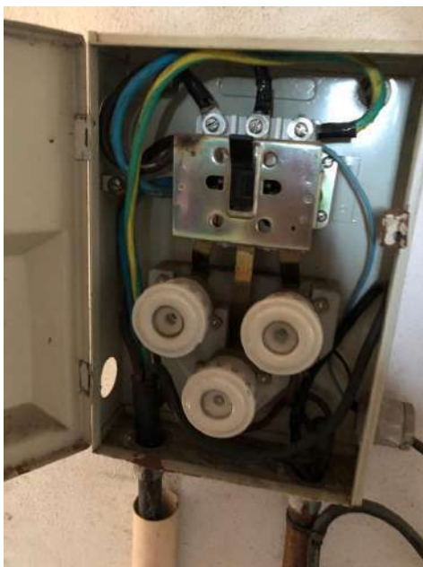
Figura 6.32 – Tablero general sala de máquinas montacargas 2 (Fuente: Elaboración propia)
