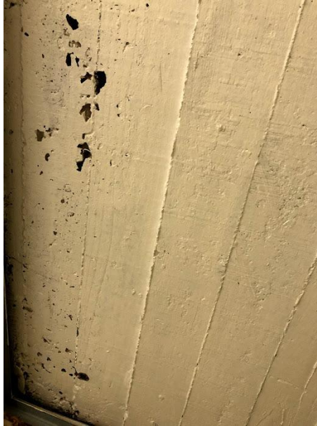
Figura 1. Huecos en una losa.
