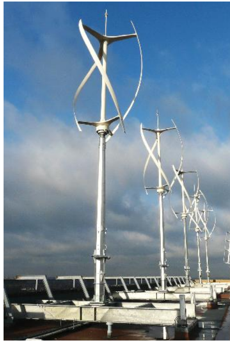
Figura 3: VAWTs del tipo helicoidal en terraza de edificio
