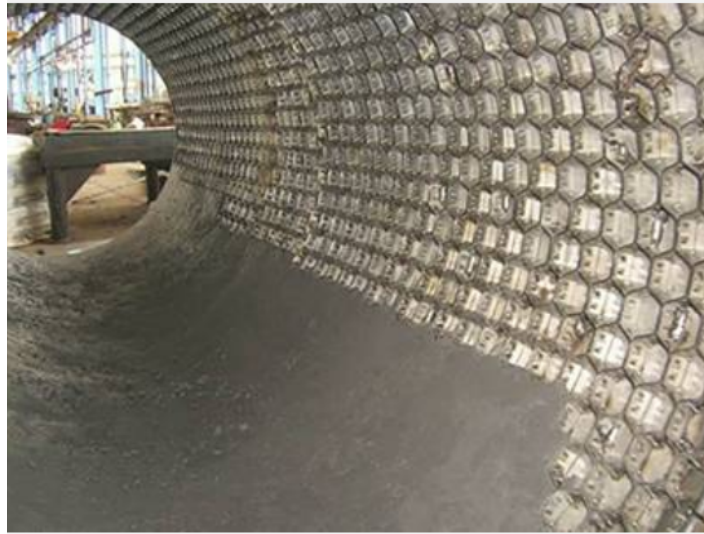
Figura 4.4. Interior de un equipo recubierto por lining refractario 43
