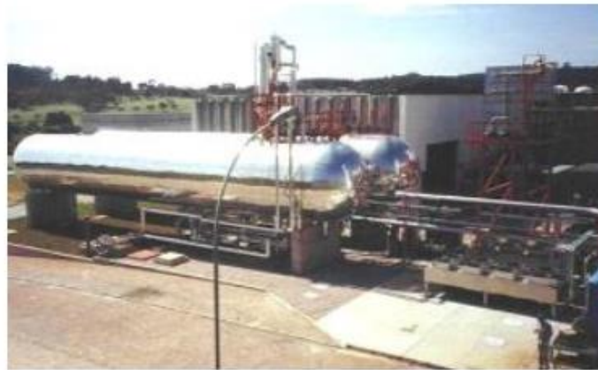
Figura 8.8: Tanque almacenaje de CO 2
