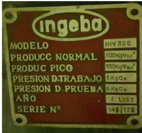
Figura 20. Chapa identificatoria caldera 3 Fuente: Elaboración propia
