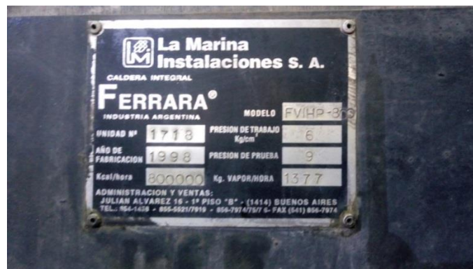
Figura 23. Chapa identificatoria caldera 5 Fuente: Elaboración propia
