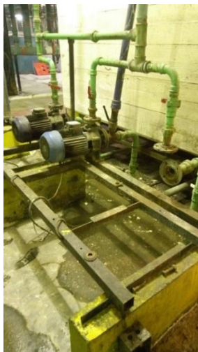
Figura 28. Bombas elevadoras de agua a los tanques Fuente: Elaboración propia
