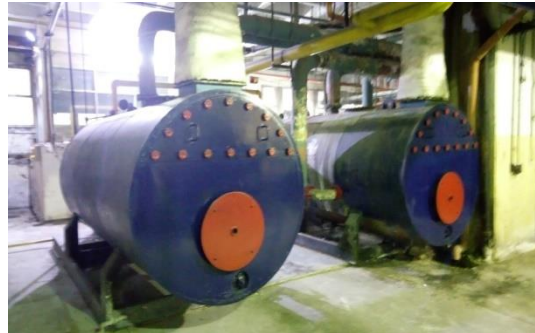
Figura 14. Calderas de baja presión 1 y 2 Fuente: Elaboración propia
