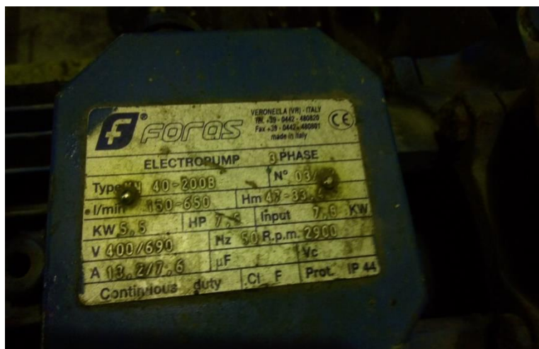
Figura 29. Identificación de las bombas elevadoras de agua a los tanques Fuente: Elaboración propia
