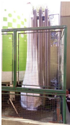
Figura 35. Cañería del tanque criogénico estacionario Fuente: Elaboración propia
