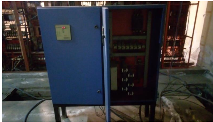
Figura 37. Banco de capacitores Fuente: Elaboración propia
