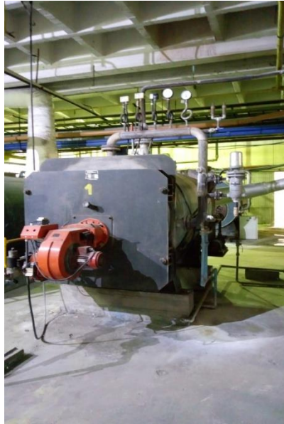
Figura 22. Caldera 5, humotubular de alta presión Fuente: Elaboración propia
