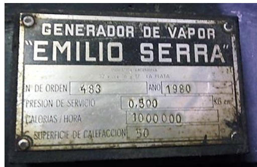
Figura 15. Especificación caldera 1 Fuente: Elaboración propia
