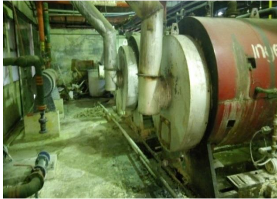
Figura 21. Acumulación de sarro detrás de las calderas Fuente: Elaboración propia
