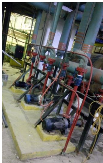
Figura 30. Bombas elevadoras para climatización Fuente: Elaboración propia
