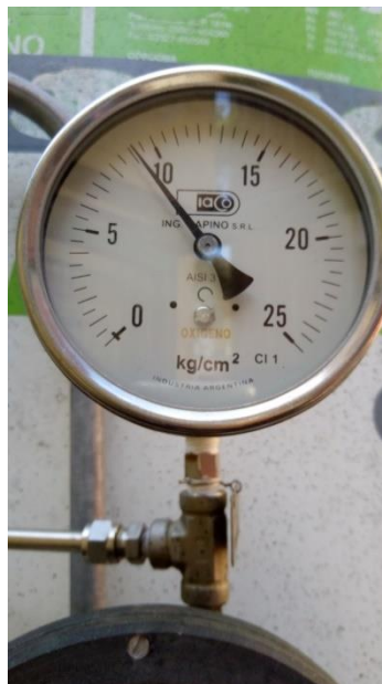
Figura 34. Manómetro del tanque criogénico estacionario de oxígeno líquido Fuente: Elaboración propia
