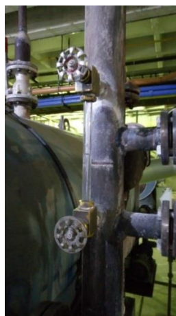
Figura 24. Visor de nivel de la caldera de alta presión Fuente: Elaboración propia
