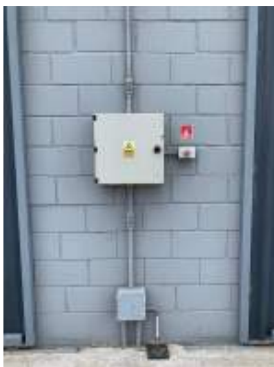
Ilustración 13: Tablero eléctrico con instalación antiexplosiva en depósitos. Fuente: Propia
