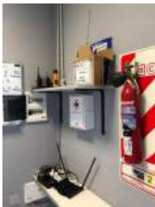
Ilustración 32: Extintor caja edificada. Fuente: Propia
