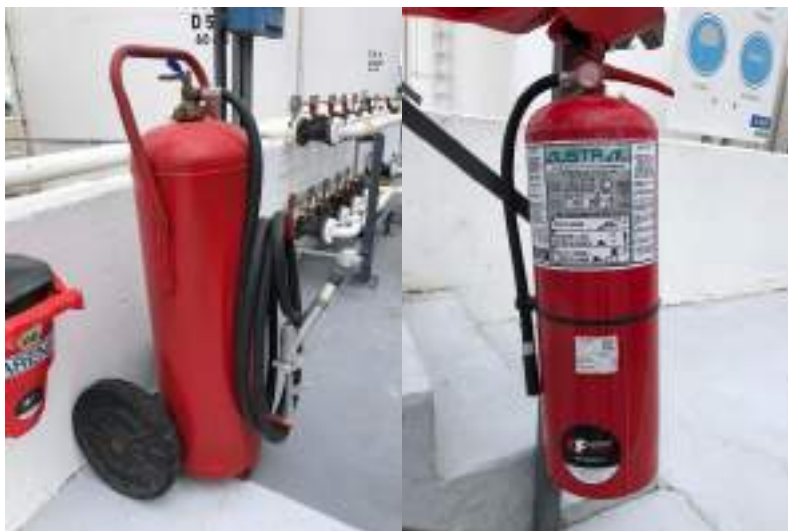
Ilustración 25: Extintores instalados de la isla de combustibles. Fuente: Propia
