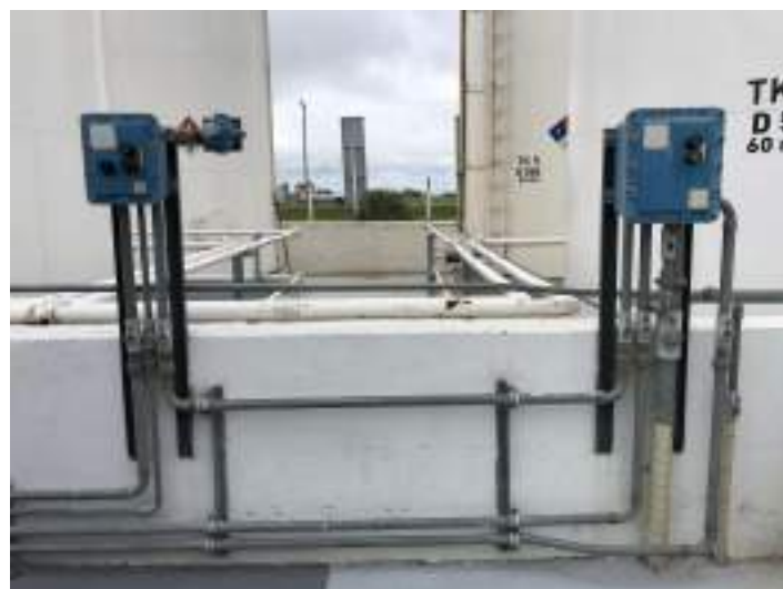
Ilustración 24: Tablero de operación isla de combustibles. Fuente: Propia
