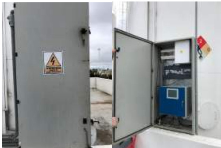
Ilustración 23: Instalación eléctrica antiexplosiva de isla de combustibles. Fuente: Propia
