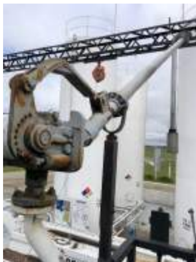
Ilustración 19: Brazo de carga de camiones. Fuente: Propia
