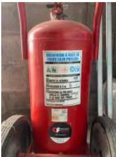
Ilustración 12: Carro extintor de polvo bajo presión en depósitos. Fuente: Propia
