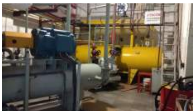
Figura 33: Sala de máquinas - Tanques recipientes y compresor a tornillo Fuente: Elaboración propia
