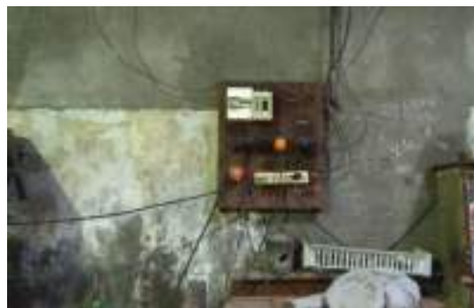
Figura 26: Panel eléctrico Fuente: Elaboración propia
