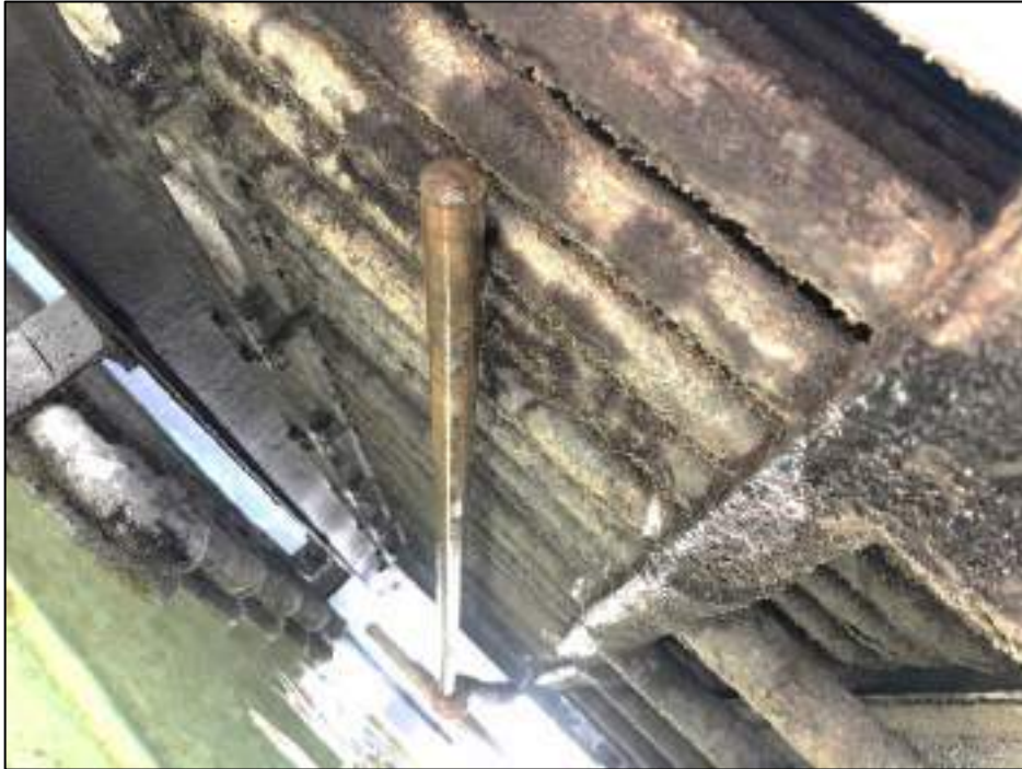
Figura 3.36 - Foto real serpentina de refrigeración (en contacto con el agua de la pileta).
