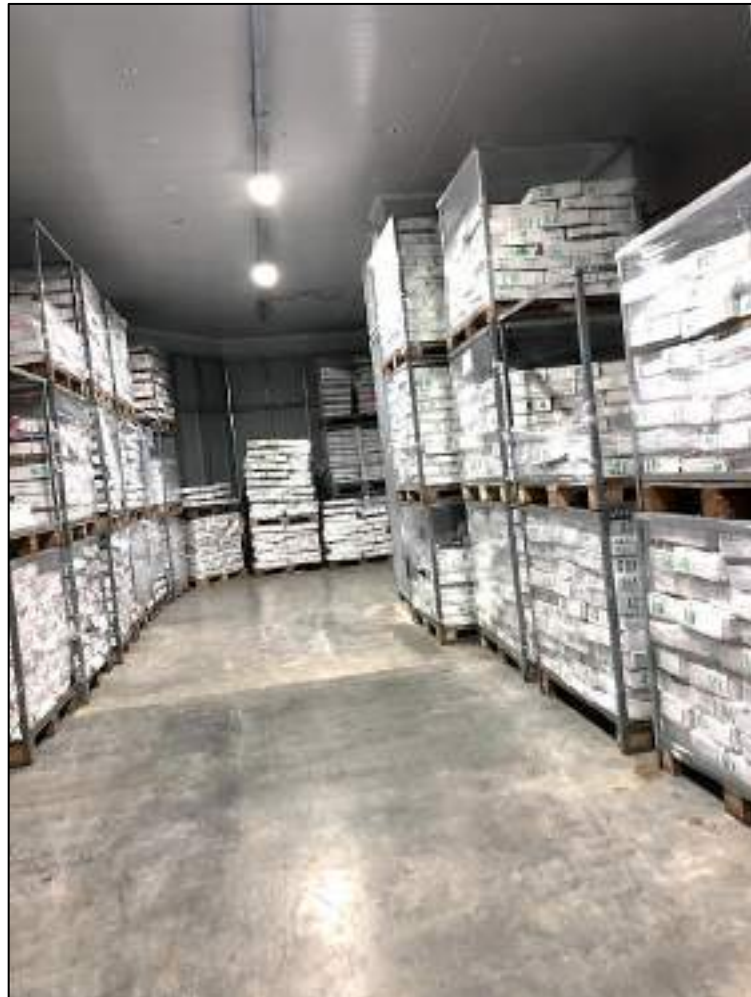
Figura 3.21 - Foto cámara de mantenimiento de producto congelado 2, (S-C2).
