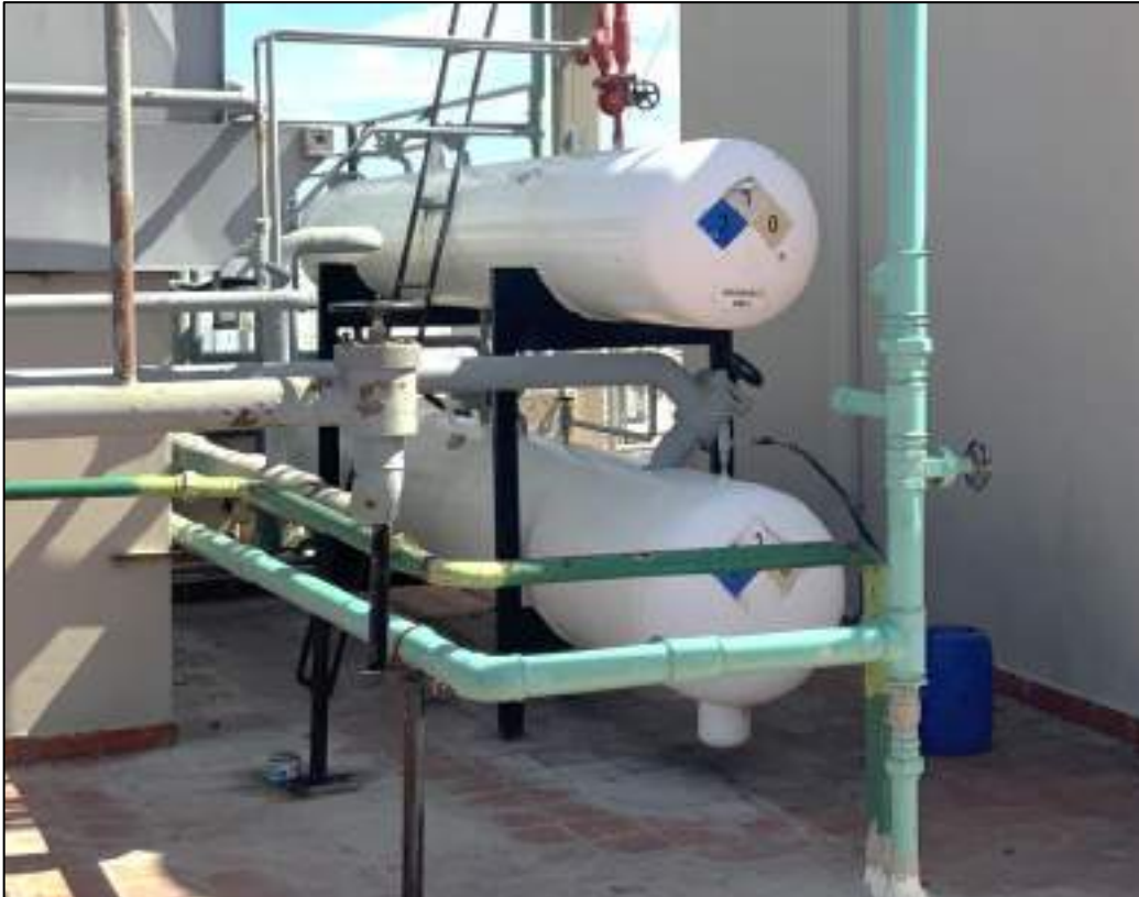
Figura 3.44 - Tanque recibidor de líquido (abajo) y tanque de maniobras (arriba) instalados en planta
