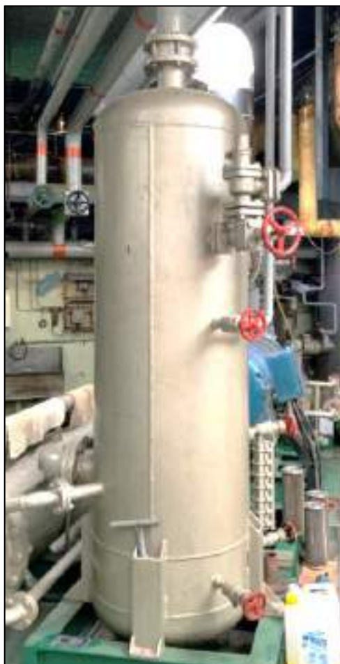
Figura 3.45 - Separador de aceite de compresor a tornillo instalado en planta.
