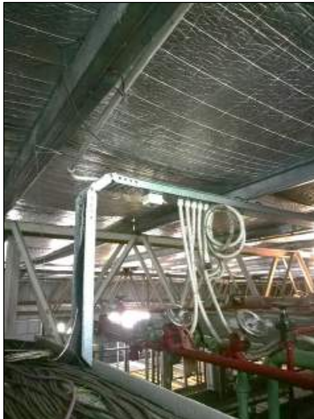
Figura 5.3 - Detector de NH 3 , válvulas de mando de cámaras de mantenimiento de congelado 4 y 5 (S-C4 y S- C5).
