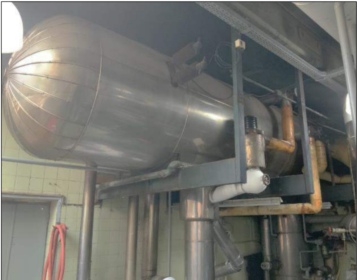
Figura 3.52 - Tanque separador de recirculado 1 ( R-SR-01 ).
