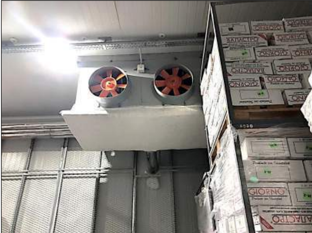
Figura 3.20 - Foto evaporador cámara mantenimiento de producto congelado 2 (S-C2).
