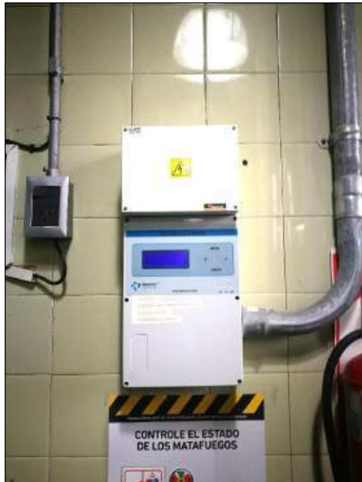
Figura 5.1 - Central de Alarmas.
