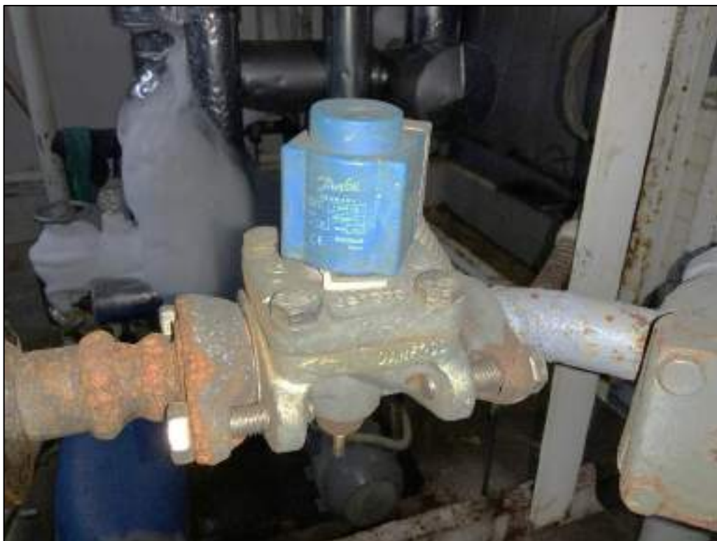
Figura 3.58 - Foto real válvula solenoide instalada en planta.
