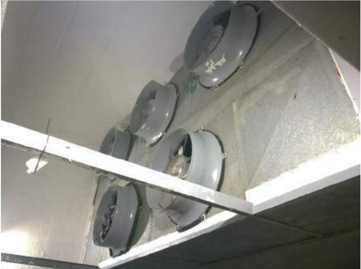
Figura 3.25 - Evaporador de túnel de congelamiento 1 (S-T01), ídem túnel 2 (S-T02)
