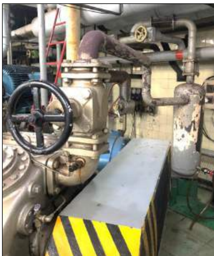
Figura 3.46 - Separador de aceite de compresor a pistón instalado en planta.
