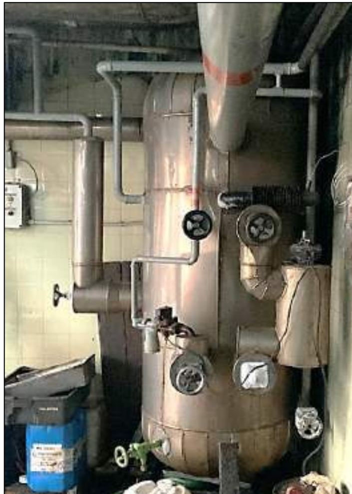
Figura 3.47 - Enfriador intermediario general instalado en planta.
