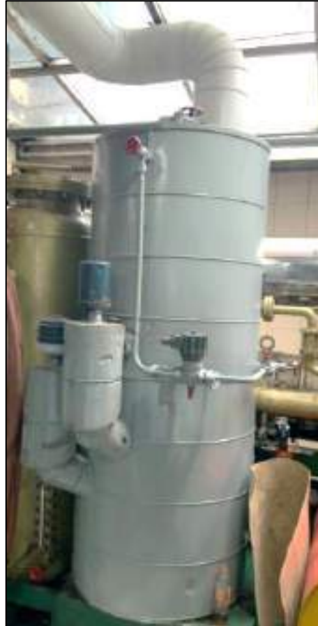
Figura 3.48 - Enfriador intermediario economizador perteneciente a compresor doble etapa instalado en planta.
