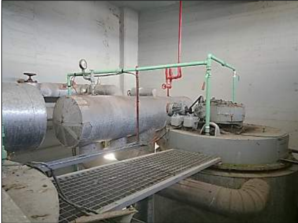
Figura 3.27 – Foto máquina de hielo 1 (S-MH1).
