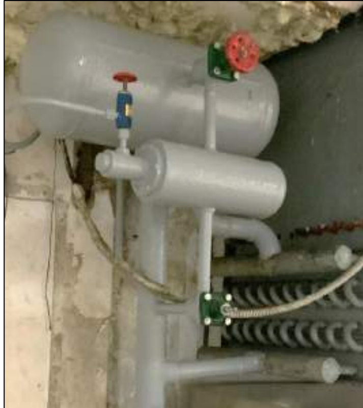
Figura 3.62 - Foto real válvula flotadora de nivel instalada en planta.
