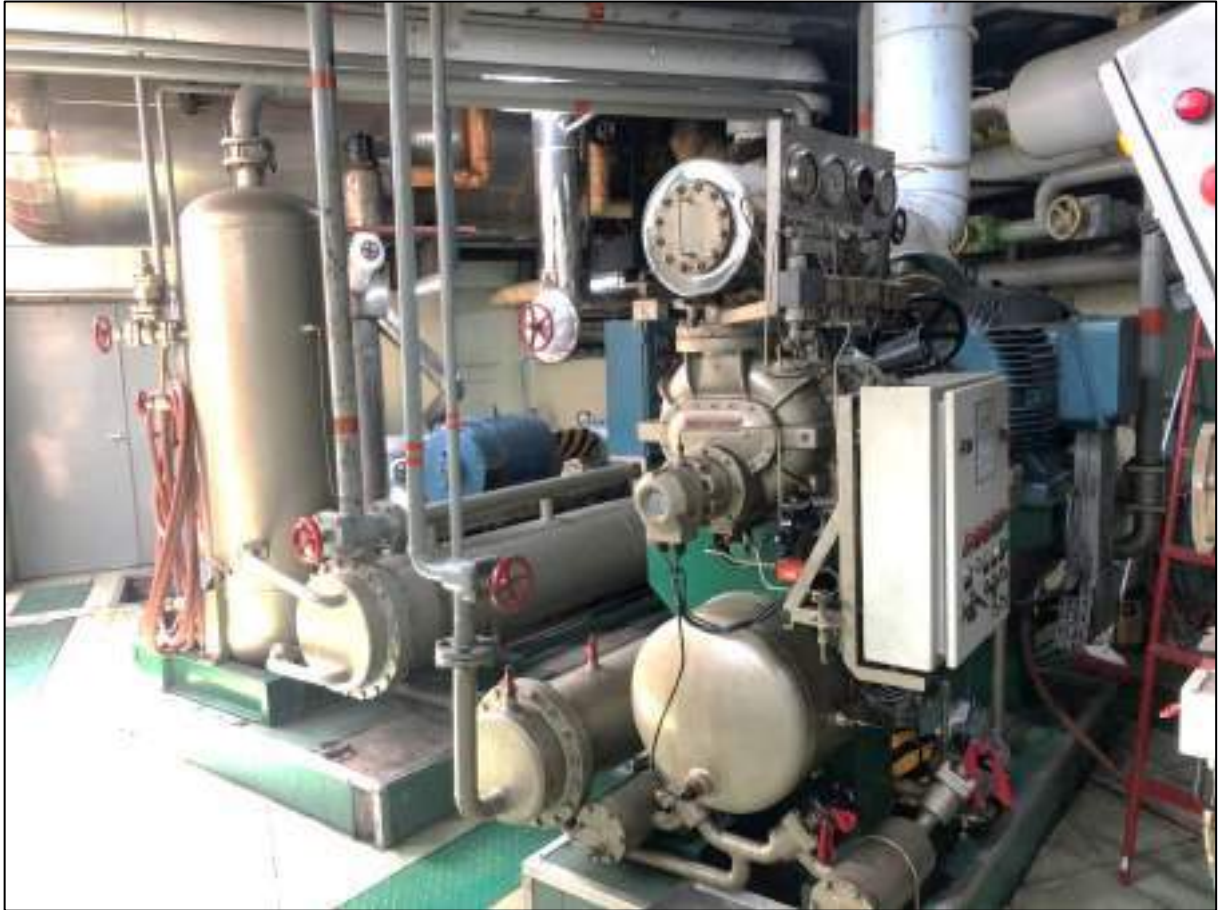
Figura 3.5 - Imagen real de la Sala de Máquinas, foto 2.
