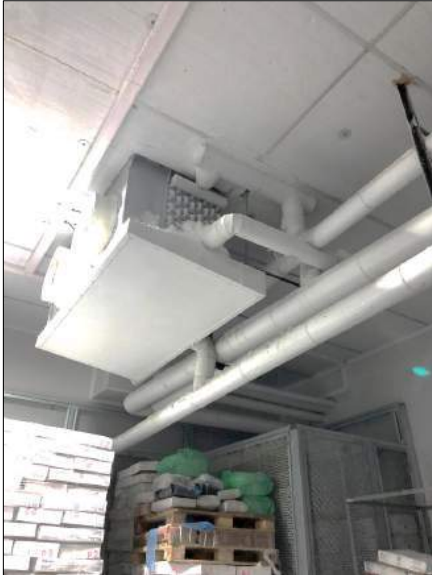
Figura 3.18 - Foto evaporador cámara mantenimiento de producto congelado 1 (S-C1)
