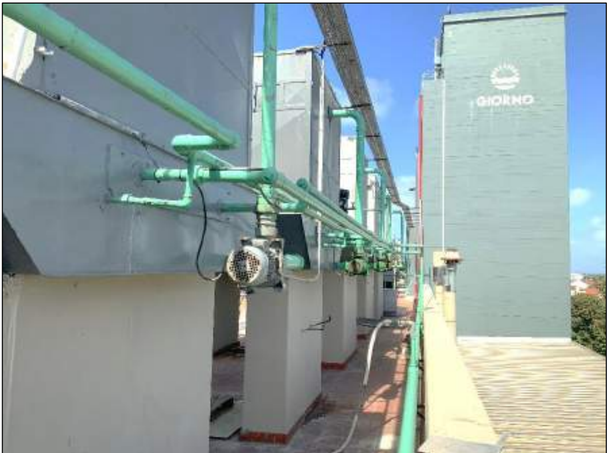
Figura 3.43 - Foto del sistema de recirculación de agua por bombas de los condensadores evaporativos
