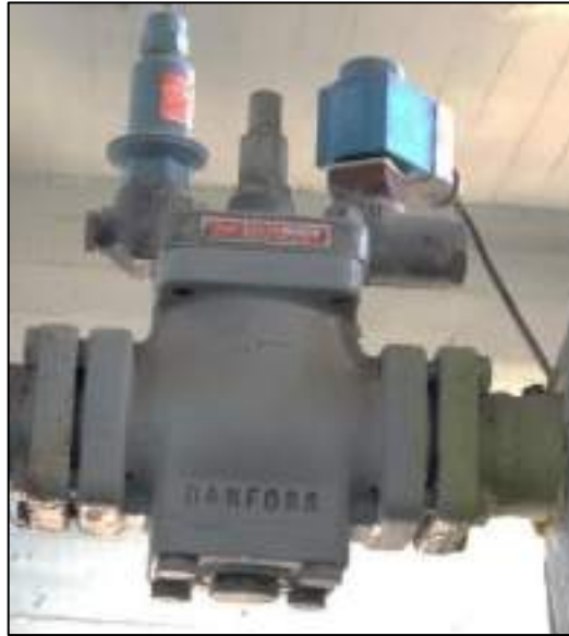
Figura 3.64 - Foto de válvula reguladora de presión instalada en planta
