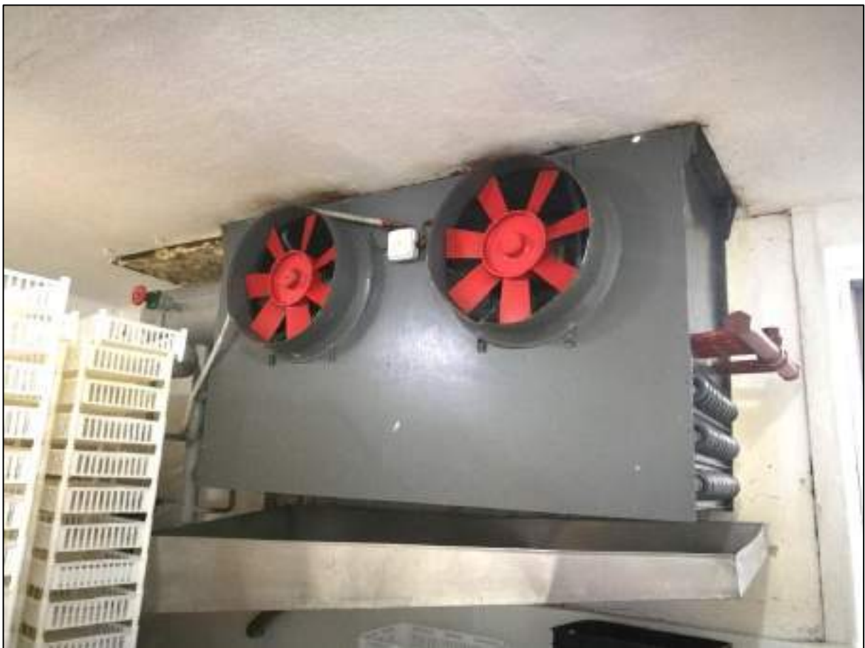
Figura 3.38 - Foto real de evaporador, frente.
