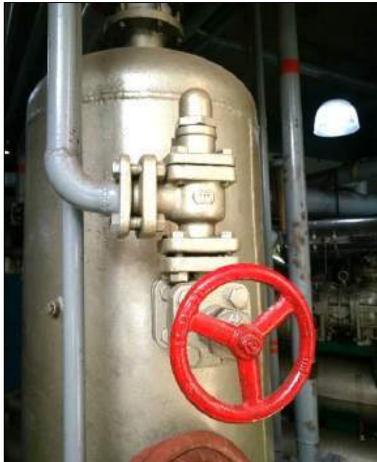
Figura 3.68 - Foto real válvula de seguridad instalada en planta en un separador de aceite.
