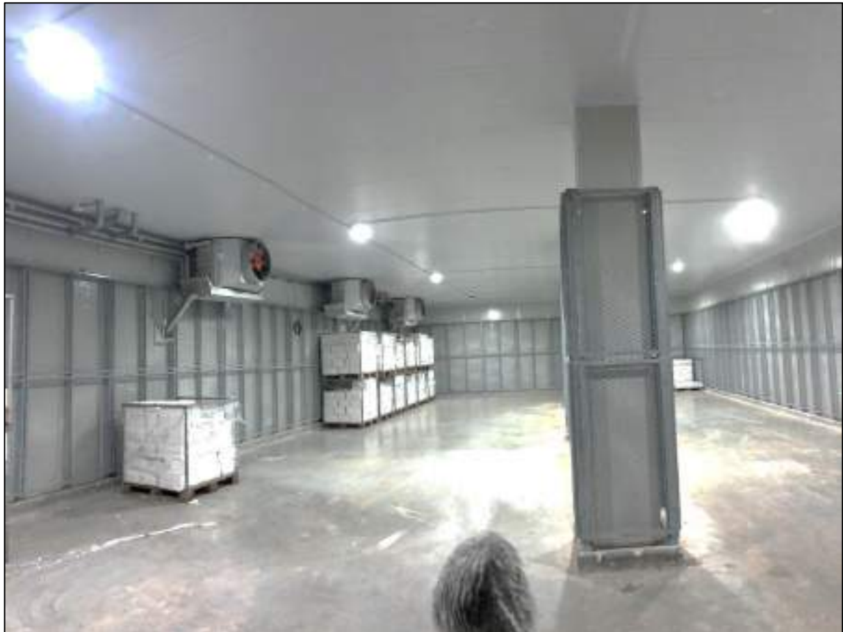
Figura 3.22 - Foto real cámara de mantenimiento de producto congelado 3, (S-C3)
