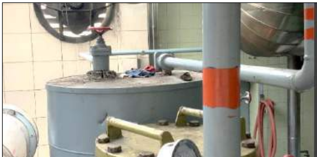
Figura 3.49 - Vista superior del enfriador intermediario economizador instalado en planta.
