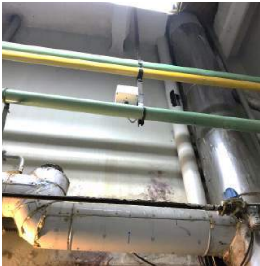
Figura 5.5 - Detector NH 3 , ingreso a silo de hielo.
