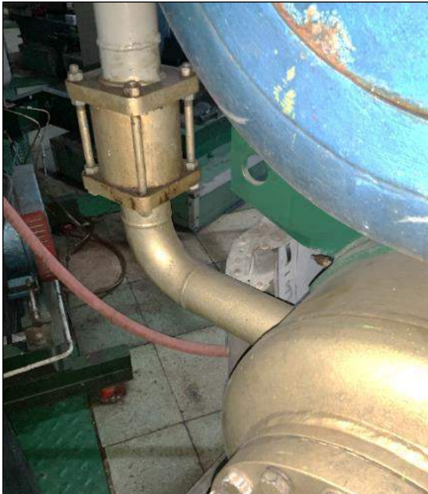
Figura 3.67 - Válvula de retención instalada en la planta.
