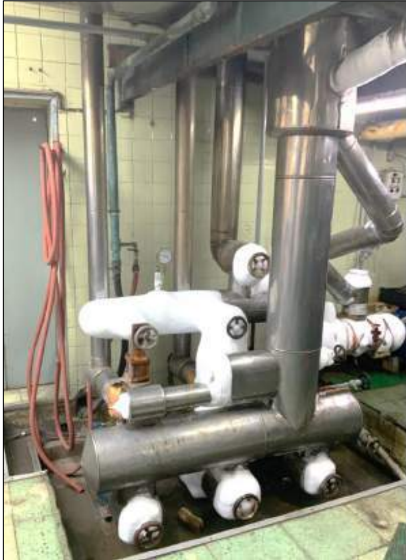
Figura 3.53 - Estación de bombeo asociada a R-SR-01.
