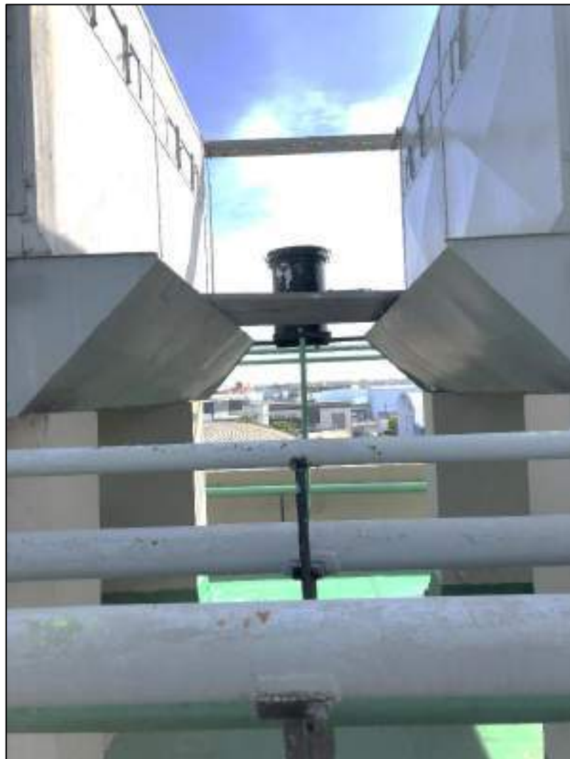
Figura 3.37 - Foto real tanque de expansión.
