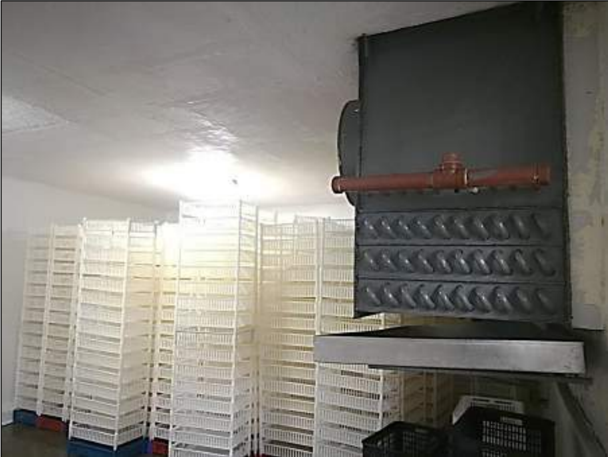
Figura 3.16 - Foto real cámara de mantenimiento de producto fresco 1 (S-CF1)
