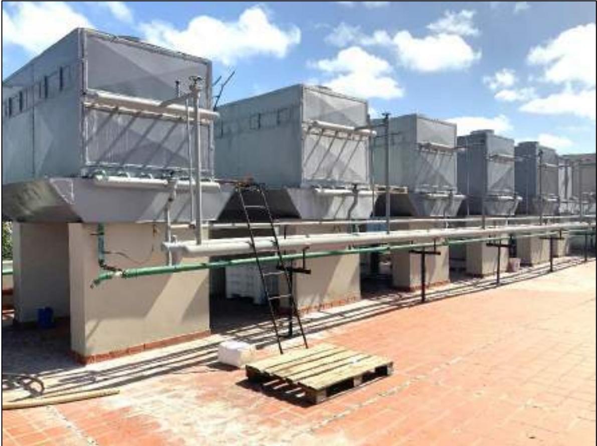
Figura 3.42 - Condensadores evaporativos instalados en la planta
