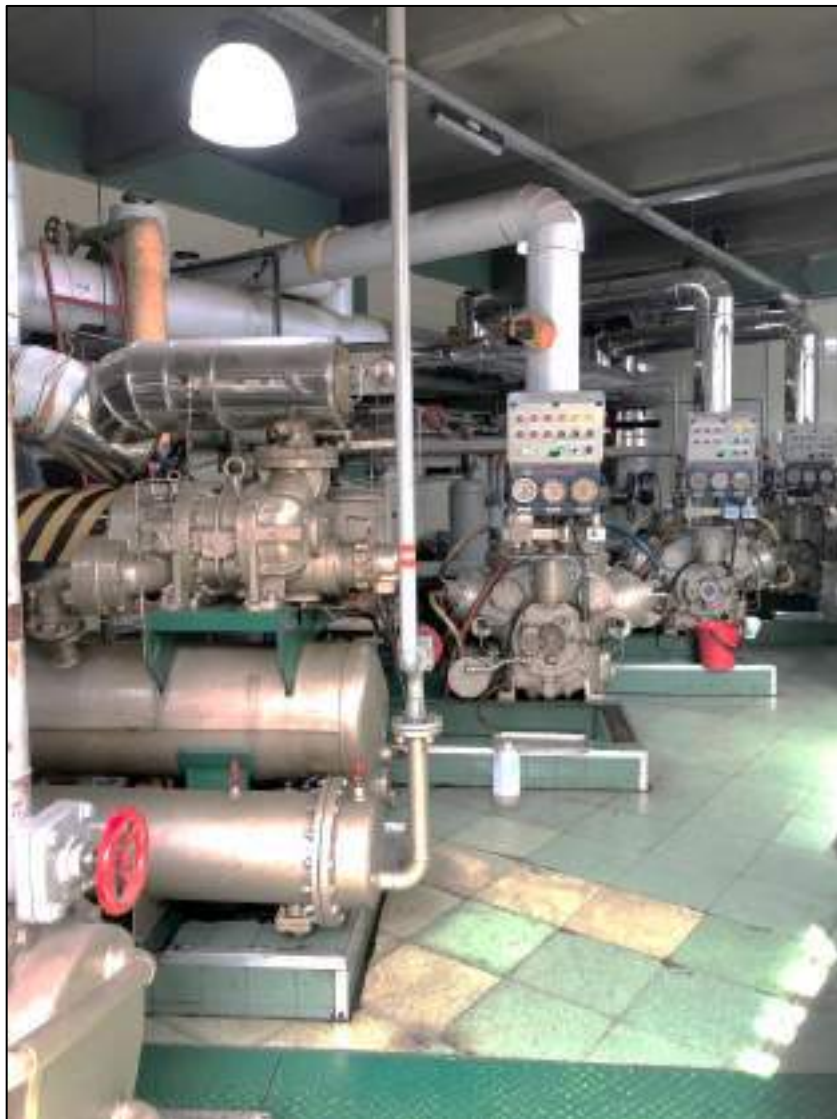
Figura 3.4 - Imagen real de la Sala de Máquinas, foto 1.
