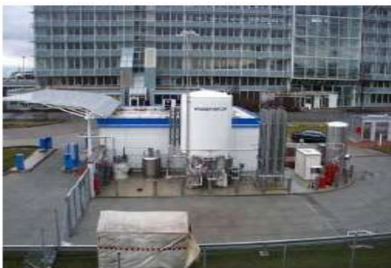
Figura 4.4.5.2: Estación “Hidrogenera” instalada en el aeropuerto de Munich [4.19]
