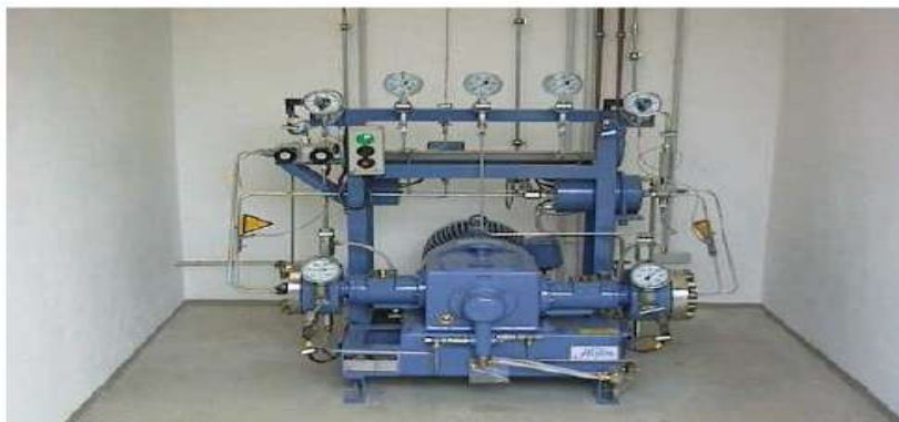
Figura 3.4.1.1: Compresor Hoffer de 350 bar de la Universidad Politécnica de Stralsund.
