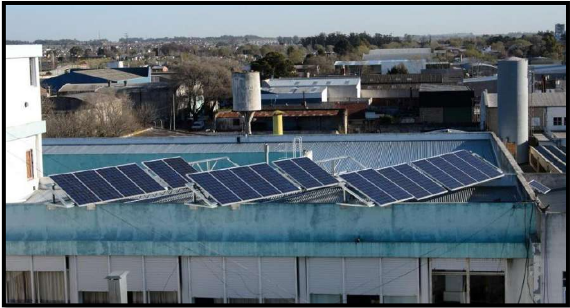
Fig. 4.1. Paneles solares instalados en la Facultad de Ingeniería
