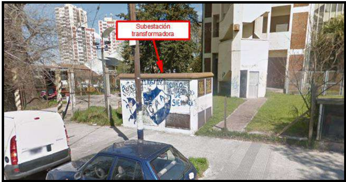
Fig. 7.11. Subestación sobre calle San Lorenzo.
