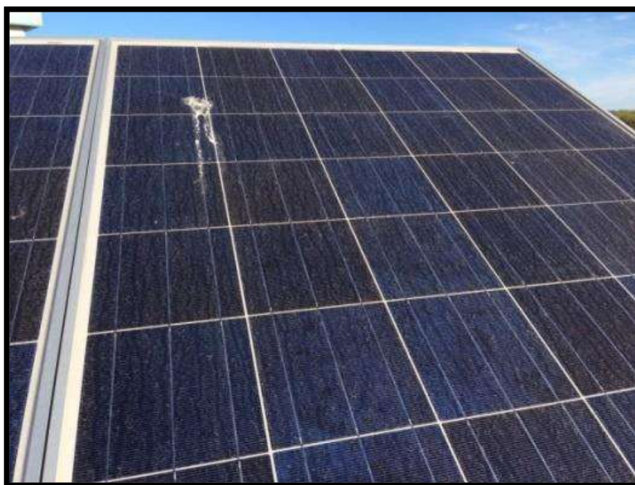
Fig. 11.32. Suciedad acumulada en los paneles. Fuente: Camila N. De Souza.
