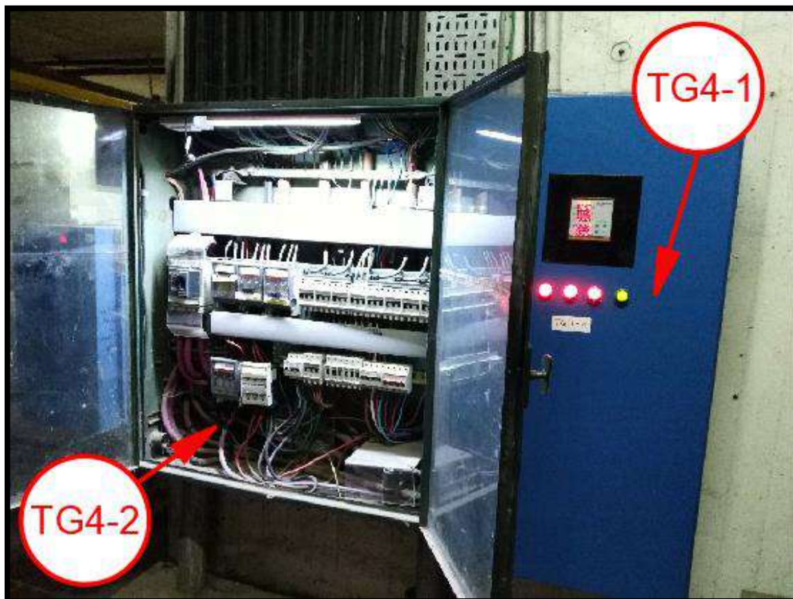
Fig. 7.5. Tableros TG4-1 y TG4-2.
