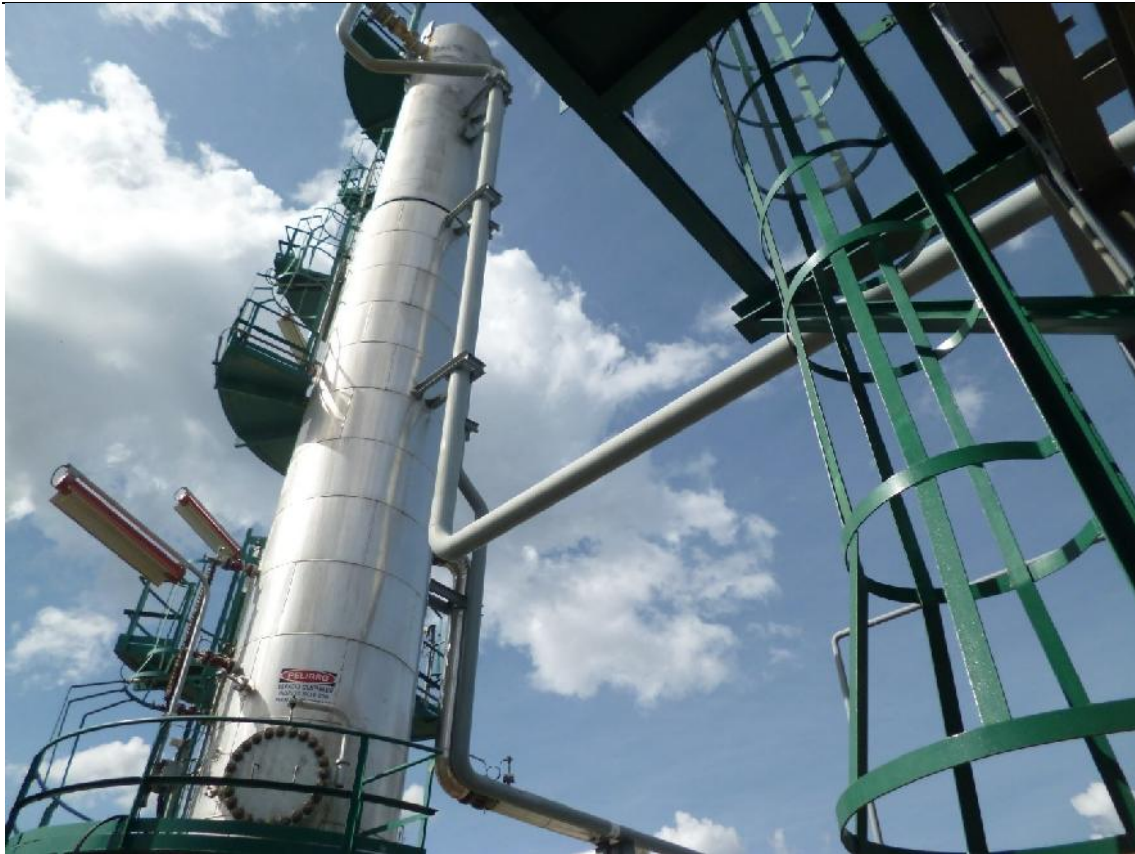
Imagen 4.1. Torre contactora de la planta.
