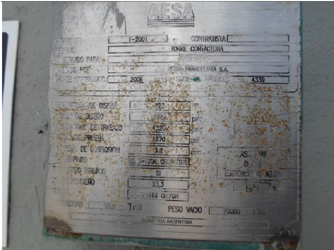
Imagen 4.2. Chapa identificatoria del activo con mayor riesgo.
