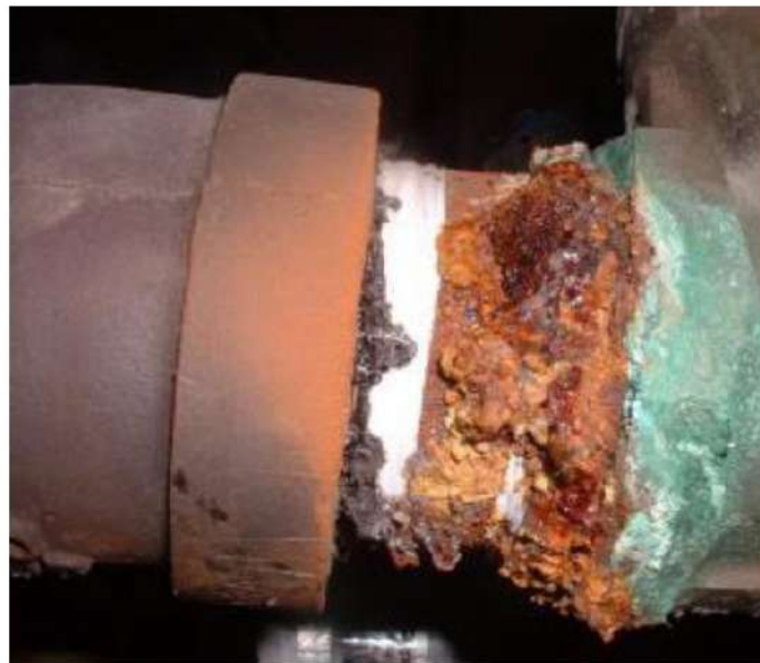
Figura 7.4. Ejemplo de corrosión galvánica.
