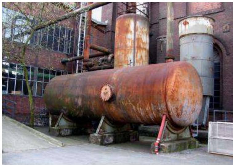
Figura 7.1. Ejemplo visual de corrosión generalizada.
