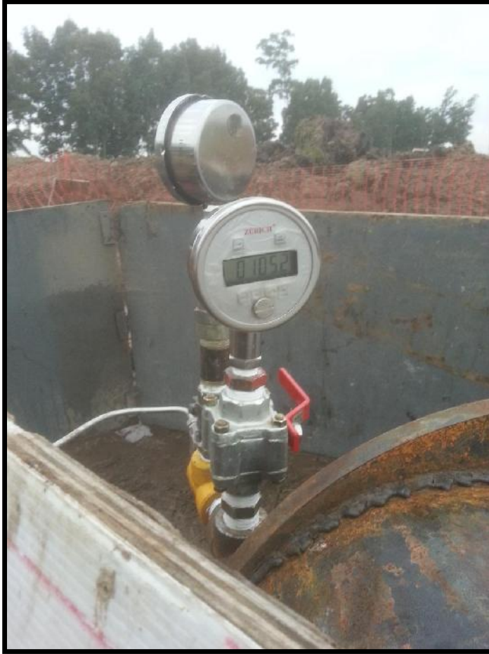
Ilustración 31. Manómetro y termómetro en prueba hidráulica.
