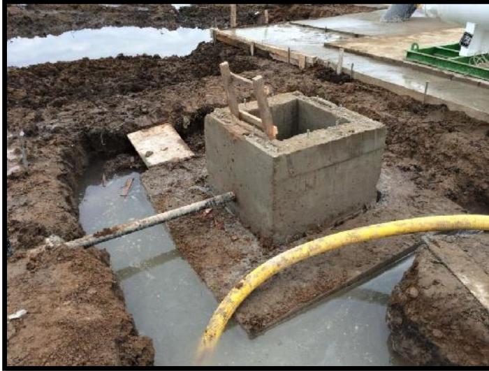
Ilustración 32. Descarga tanque de choque
