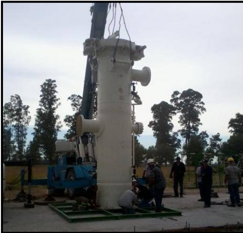
Ilustración 7. Montaje de filtro coalescente
