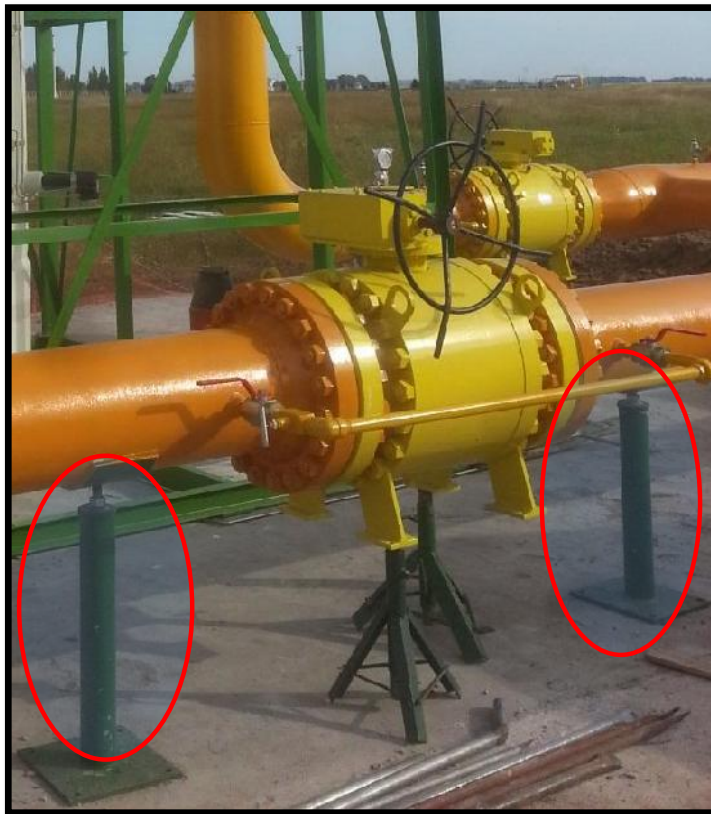
Ilustración 12. Soportería provisoria de cañería.
