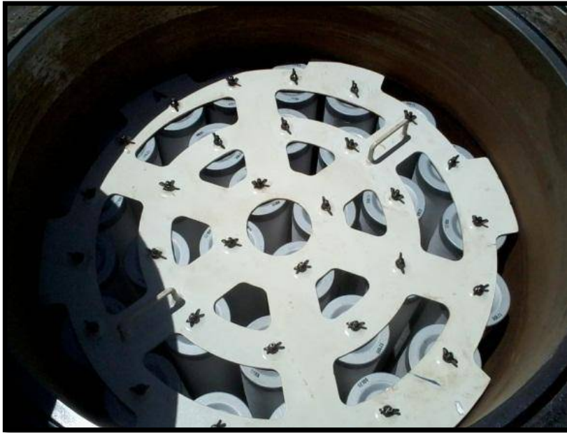
Ilustración 6. Cartuchos filtrantes en interior de filtro 5micrones
