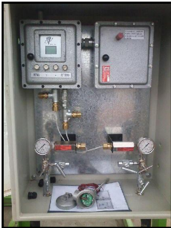
Ilustración 11. Tablero con sistema adquirente de datos
