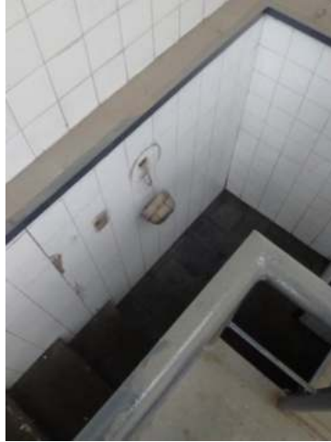
Ilustración 55. Imagen de la fosa del sector de engrase, que carece de iluminación en la zona de la escalera.
